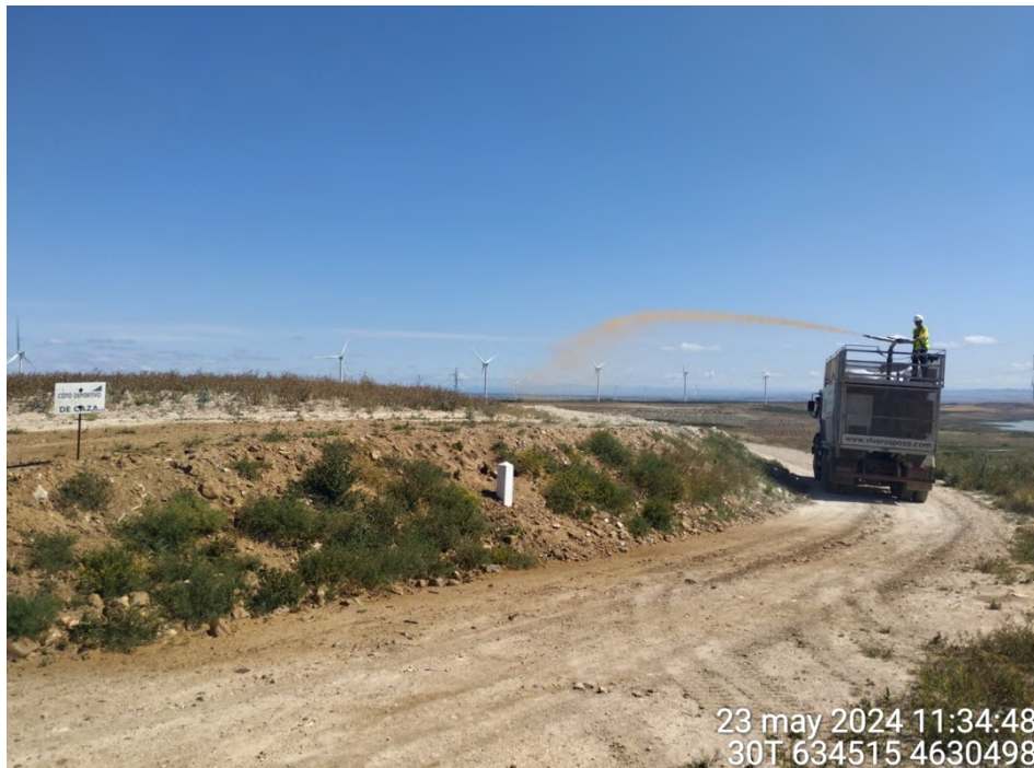
Hidrosiembra del área 1 (talud del tramo soterrado al norte de la Ermita de la Loteta)
