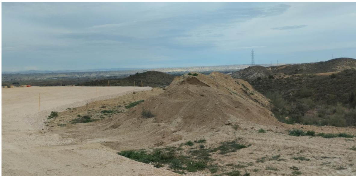
Importante acopio de tierra vegetal junto a la plataforma del ACS 01, disponible para la restauración final
