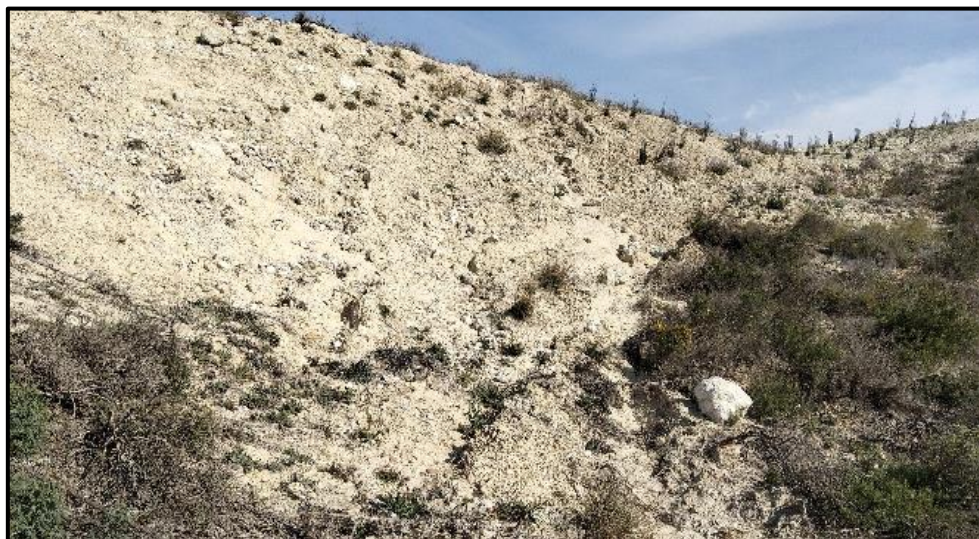
Fotografía 3. Estado actual del talud situado en el aerogenerador ACS05.
