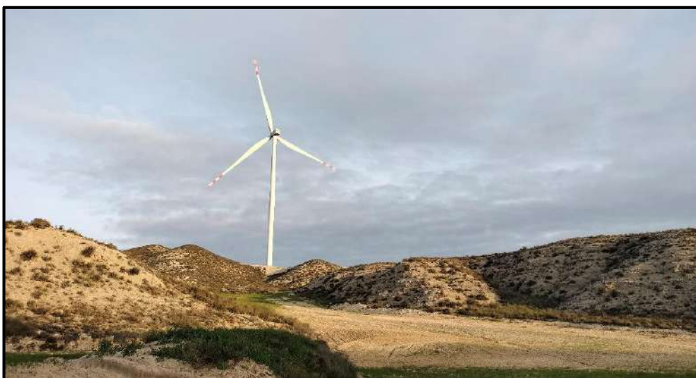
Fotografía 8. Vista general del aerogenerador ACS05.
