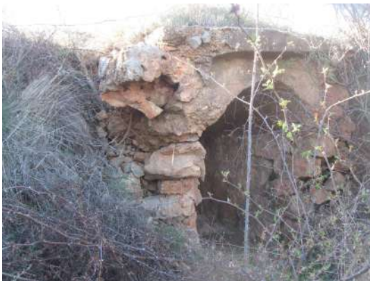
Salida de agua agua antes de la actuación.
