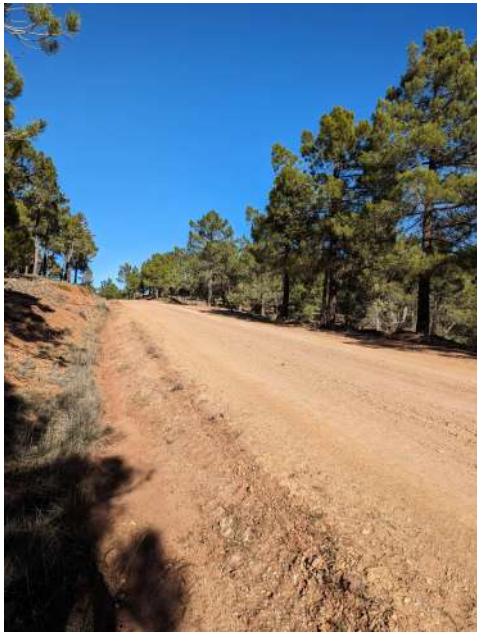
Estado final del firme en Pista Fuente de la Señora.
