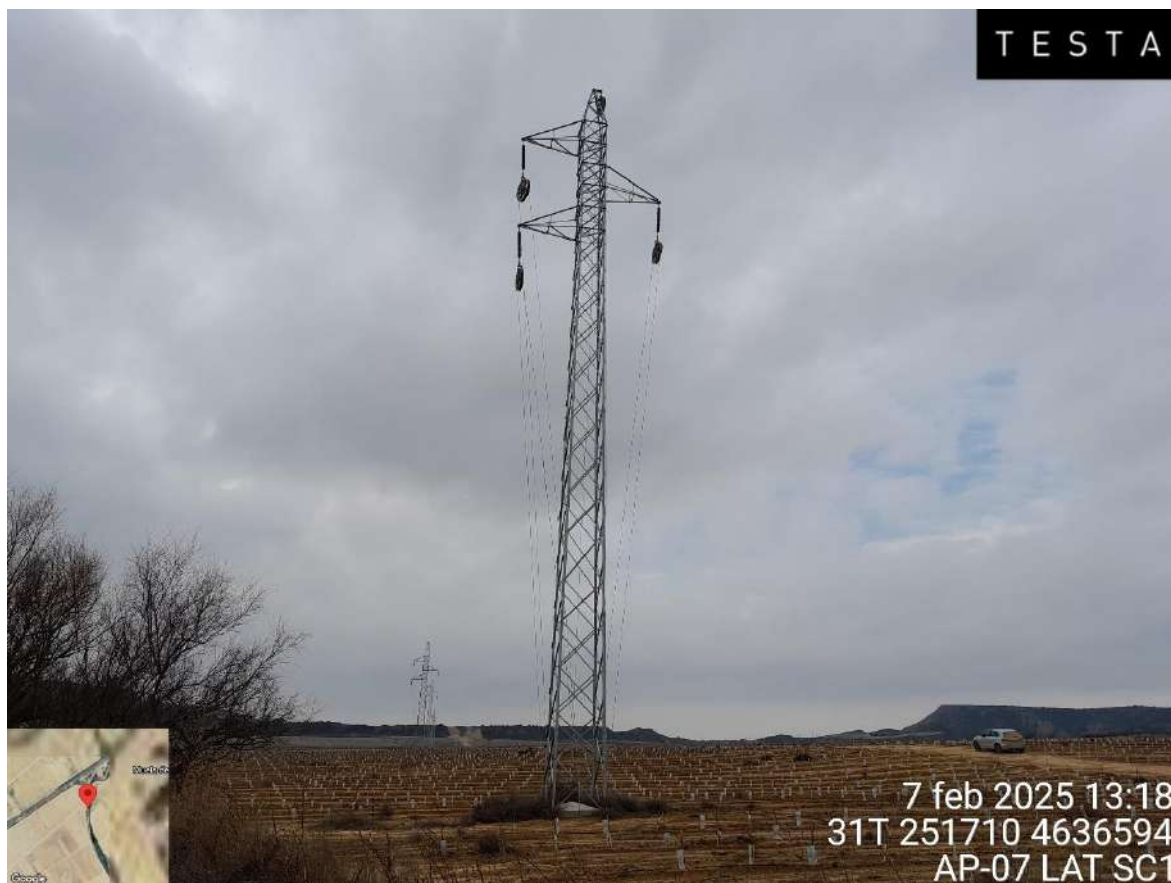
Imagen 1. Apoyo 07 de la LAT SC1
