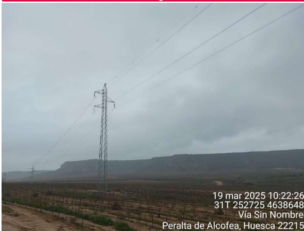
Imagen 1. Apoyo 15 con los salvapájaros instalados del modo adecuado.
