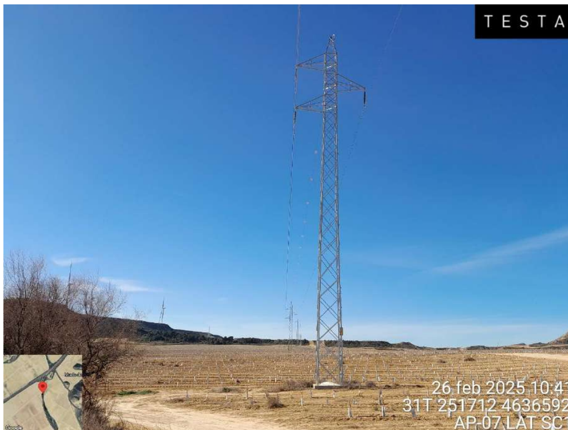
Imagen 1. Apoyo 07 de la LAT SC1
