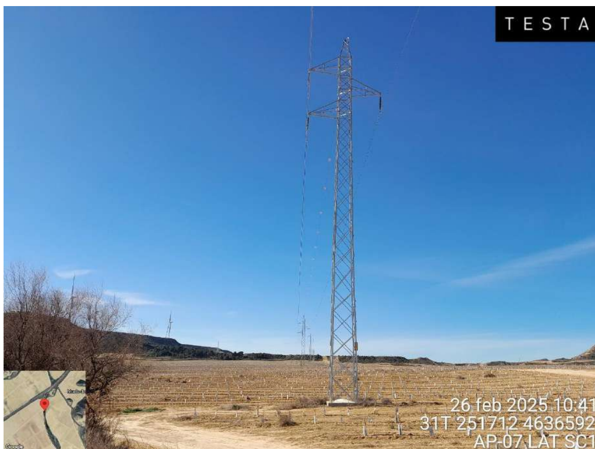
Imagen 1. Apoyo 07 de la LAT SC1
