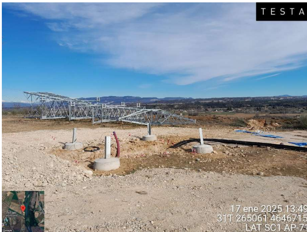
Imagen 1. Apoyo 71 de la LAT SC1 (margen derecha del río Cinca)
