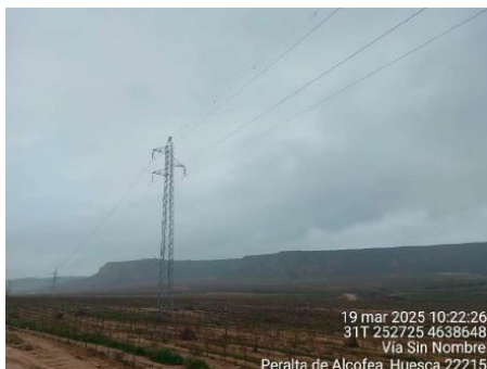
Apoyo 15 con dispositivos salvapájaros
