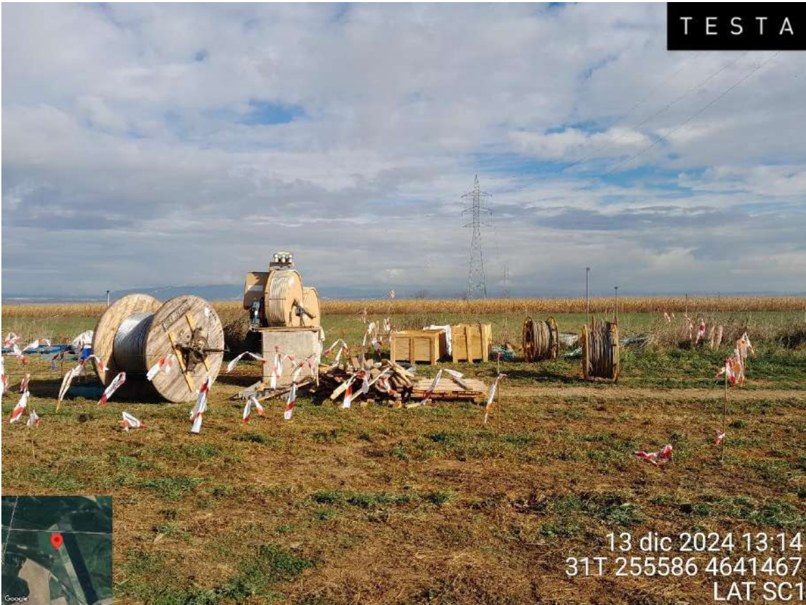
Imagen 1. Apoyos hizados de la LAT SC1
