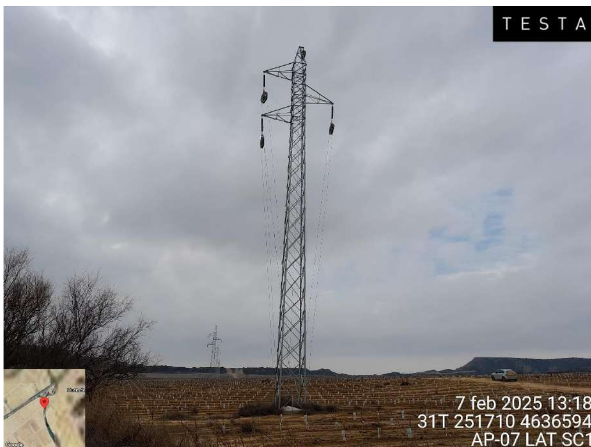
Imagen 1. Apoyo 07 de la LAT SC1
