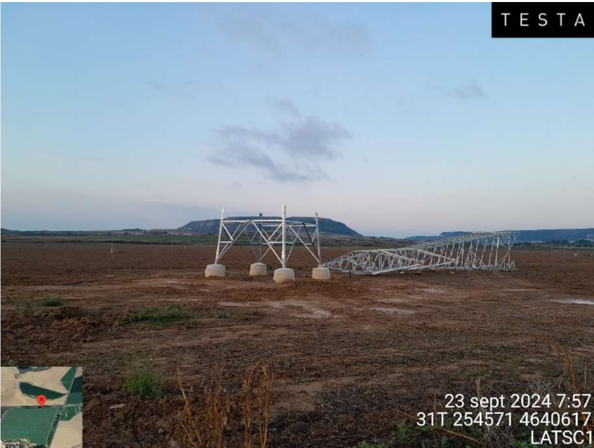
Imagen 1. Apoyo de la LAT SC1
