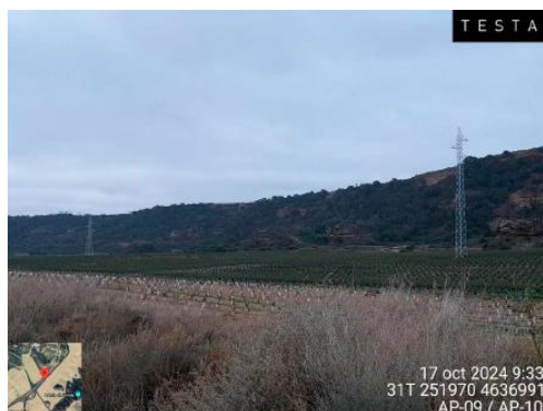
Apoyos 09 y 10 de LAT SC1
