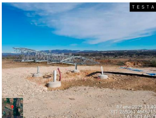
Apoyo 71 de la LAT SC1 (margen derecha del río Cinca)
