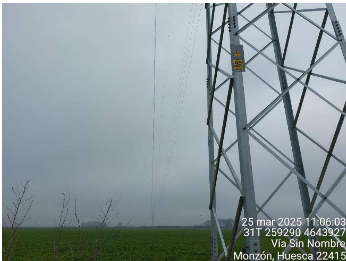
Imagen 1. Apoyo 45 junto a la línea con los salvapajaros instalados.
