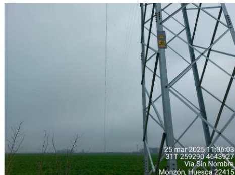
Apoyo 45 con dispositivos salvapájaros
