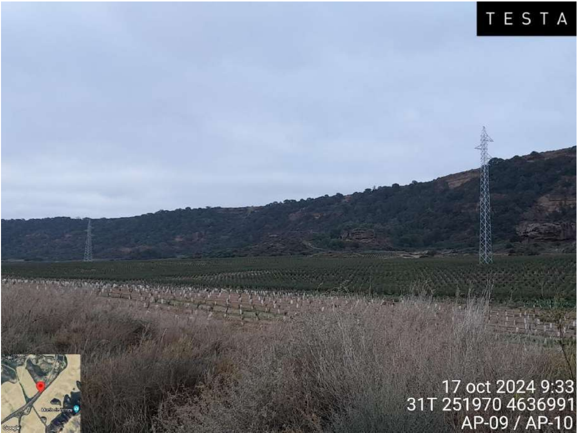
Imagen 1. Panorámica de los apoyos 09 y 10 de LAT SC1
