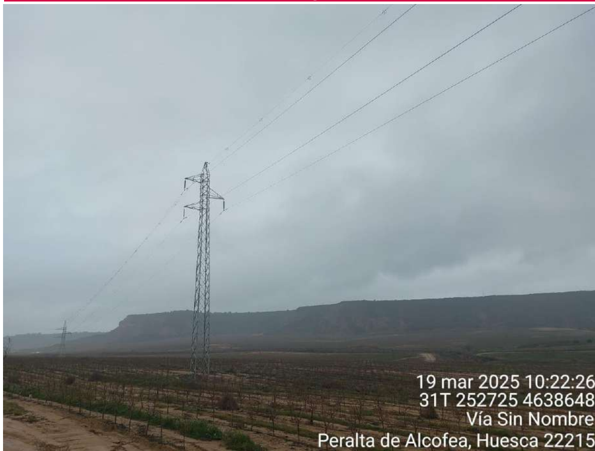
Imagen 1. Apoyo 15 con los salvapájaros instalados del modo adecuado.
