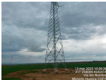
Tramo de LAT SC-Monzón con salva pájaros.
