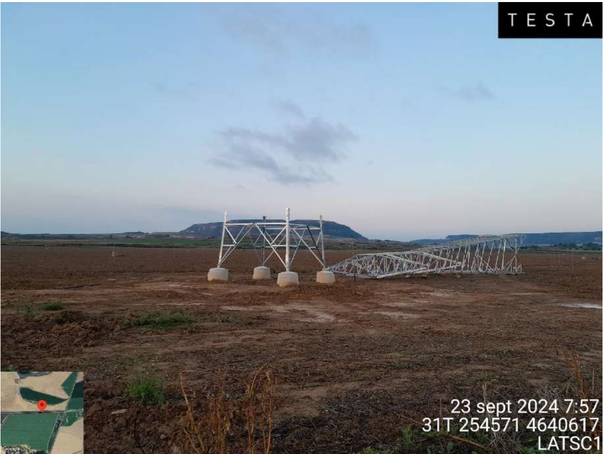
Imagen 1. Apoyo de la LAT SC1
