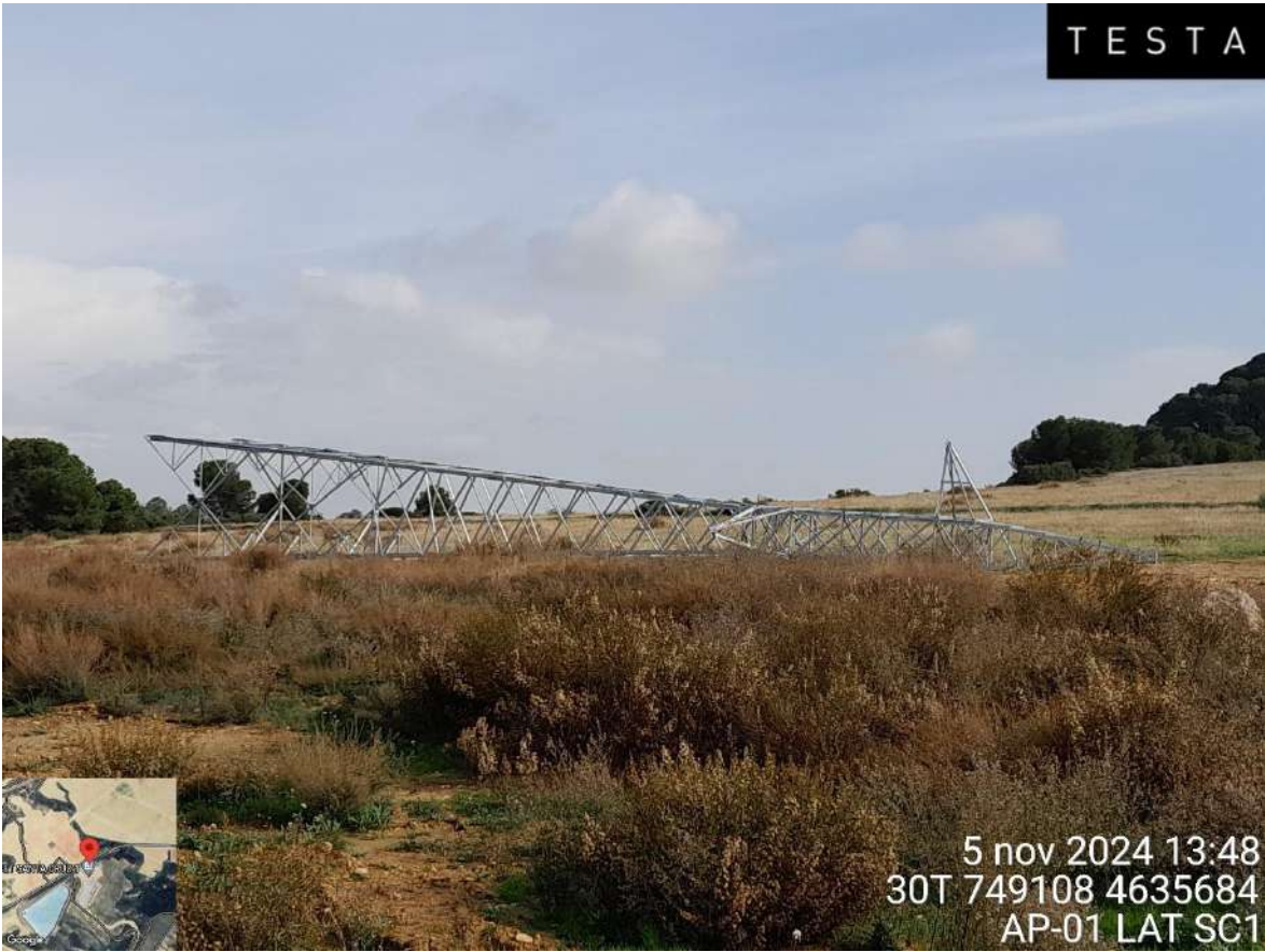
Imagen 1. Visual del apoyo 01 de la LAT SC1 junto a la SET SC1
