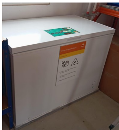
Ilustración 2. Arcón congelador ubicado en la SET
