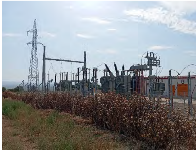
Fotografías 9 a 11: Subestación
