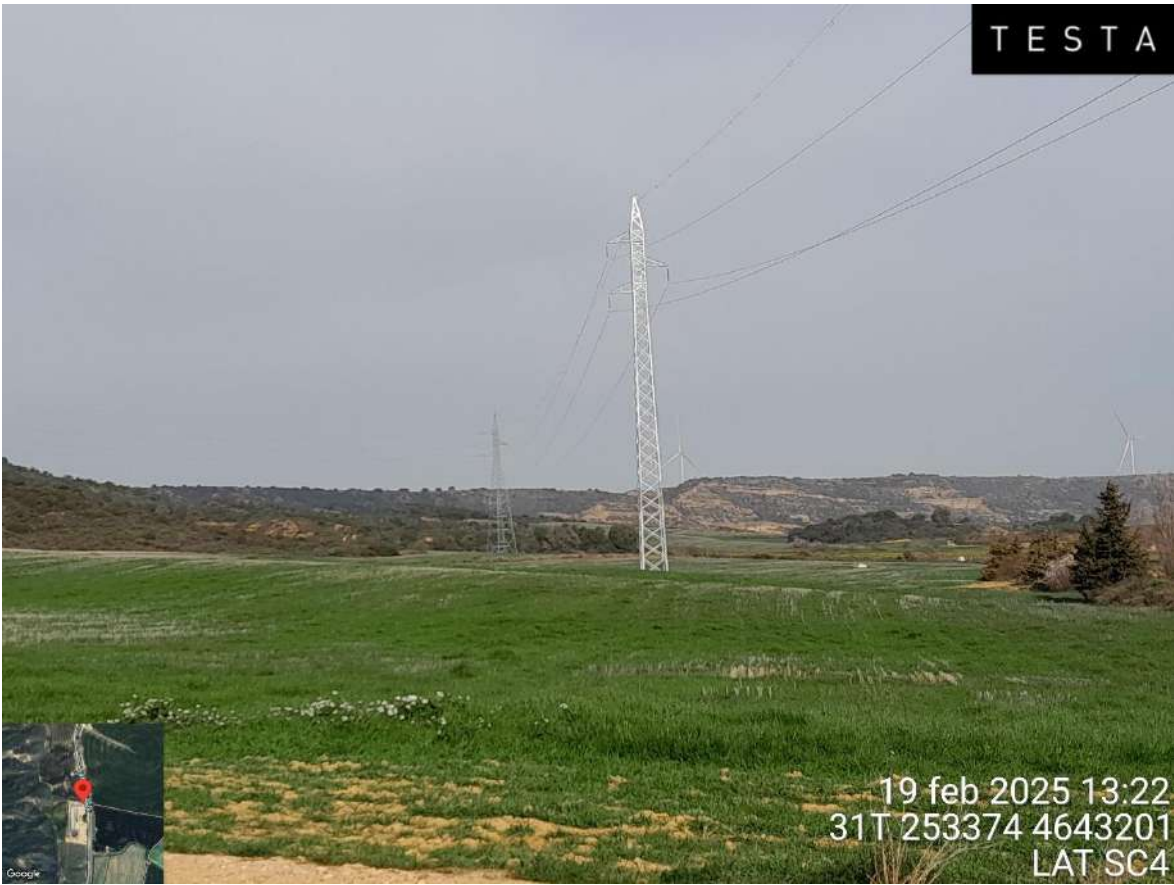
Imagen 1. Apoyos de la LAT SC4 a SET SC4
