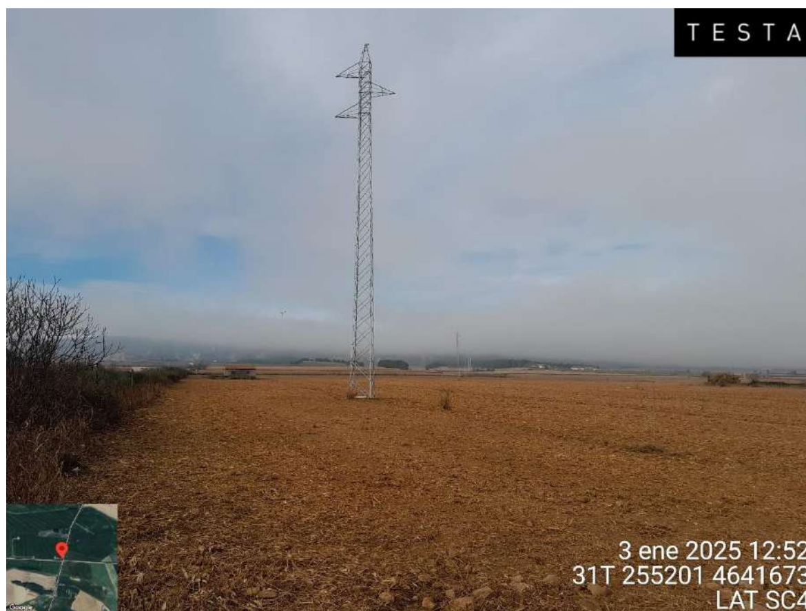
Imagen 1. Apoyos de LAT SC4
