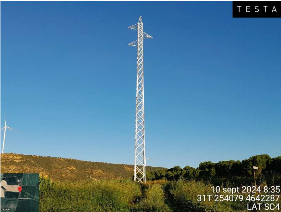
Imagen 1. Apoyo de la LAT SC4
