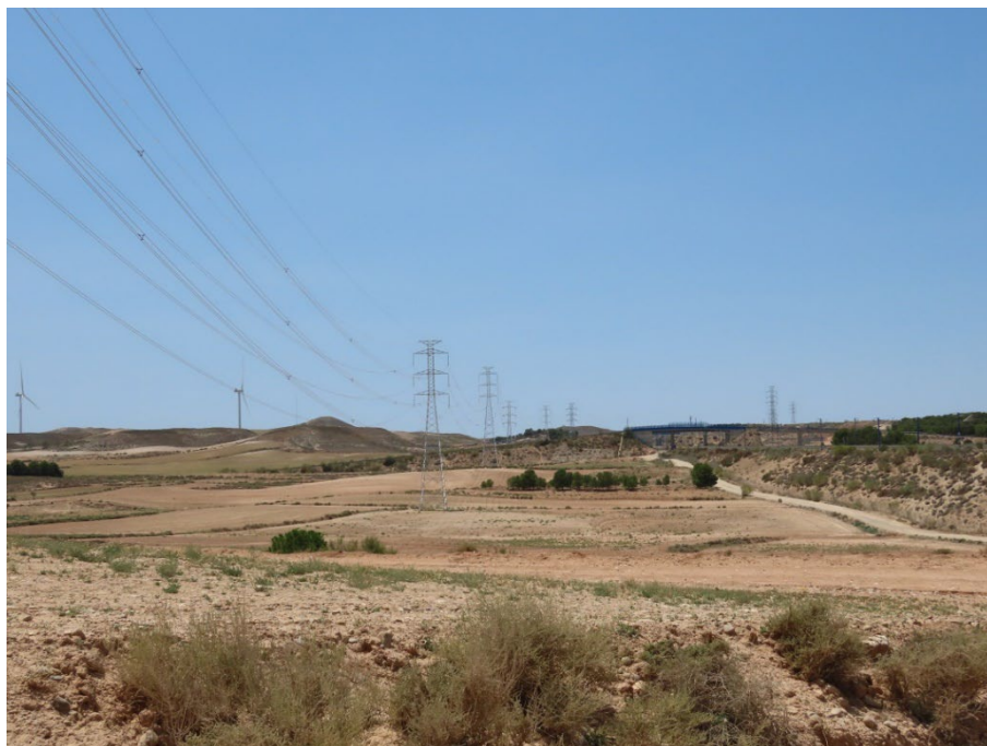
Figura 2. Línea eléctrica Fuentes-Ave
