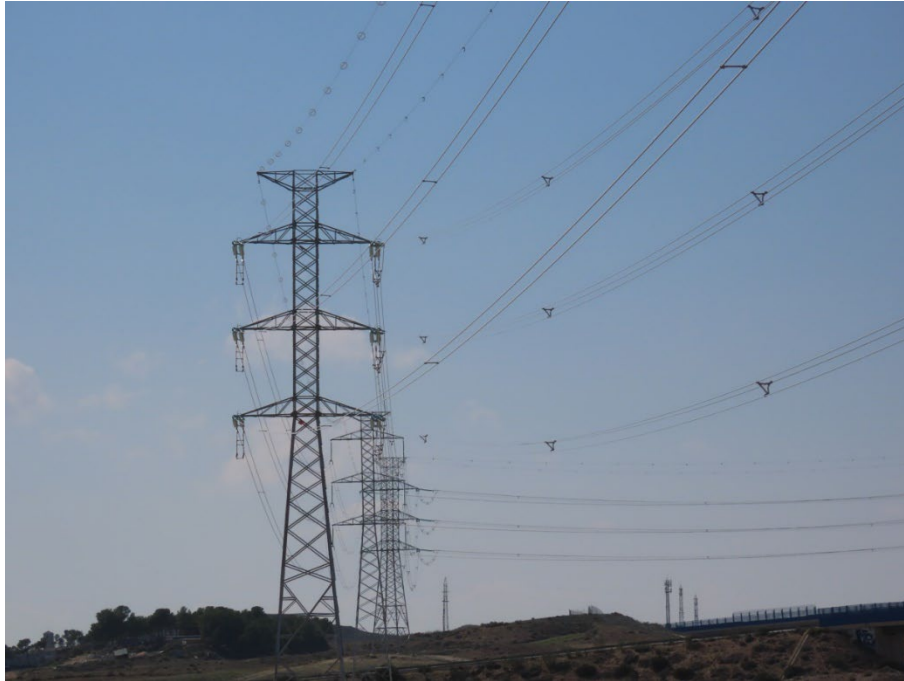
Figura 1. Línea eléctrica Fuentes-Ave
