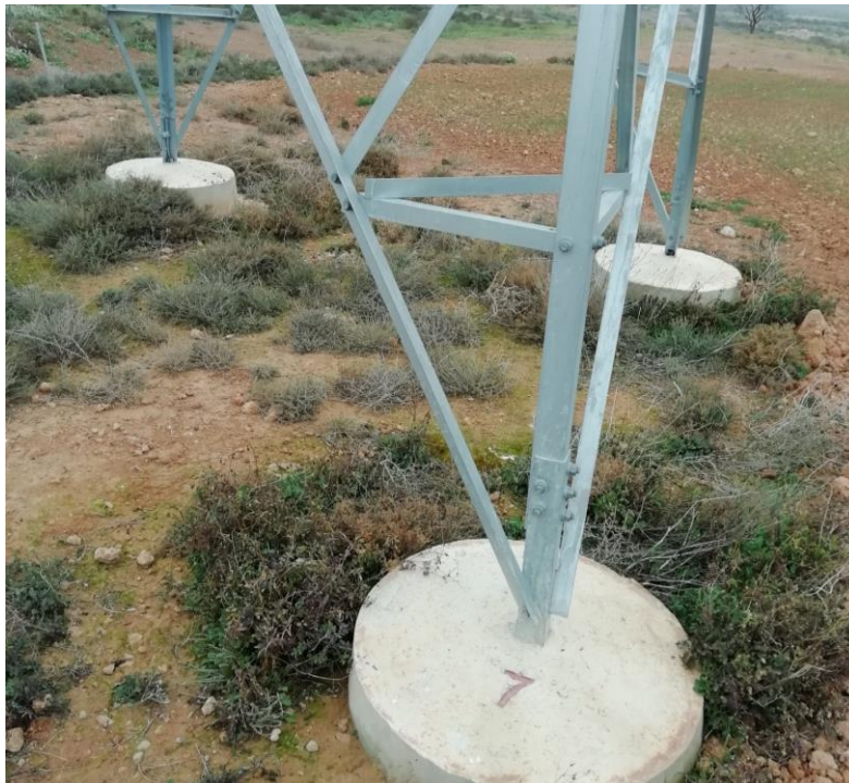
Fig.3. Estado general de apoyos.
