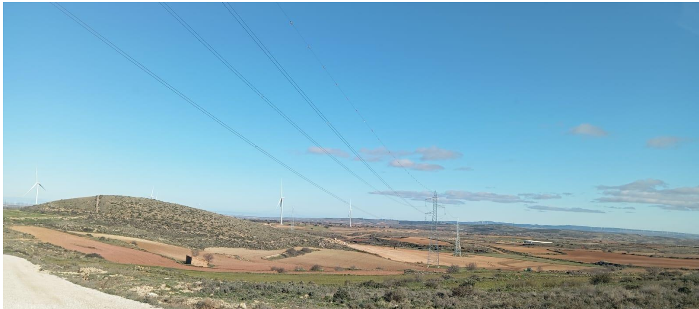
Fotografías 1 y 2: Visibilidad de la línea eléctrica
