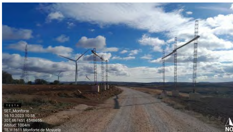
Cableado en LAT
