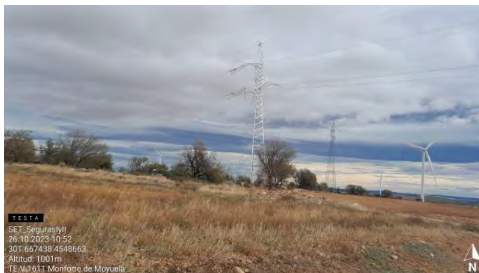
Cableado en LAT
