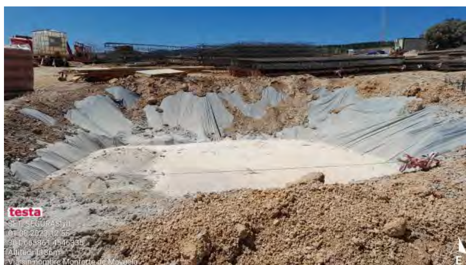
Pozo de lavado en SET Seguras.
