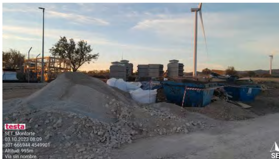
Contenedores de RNP llenos en SET Monforte.
