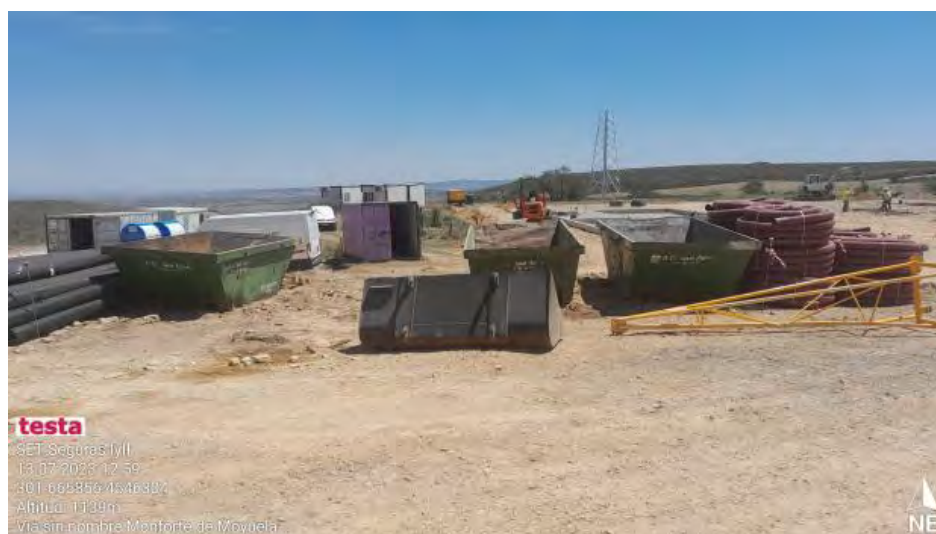
Contenedores de RNP en SET.
