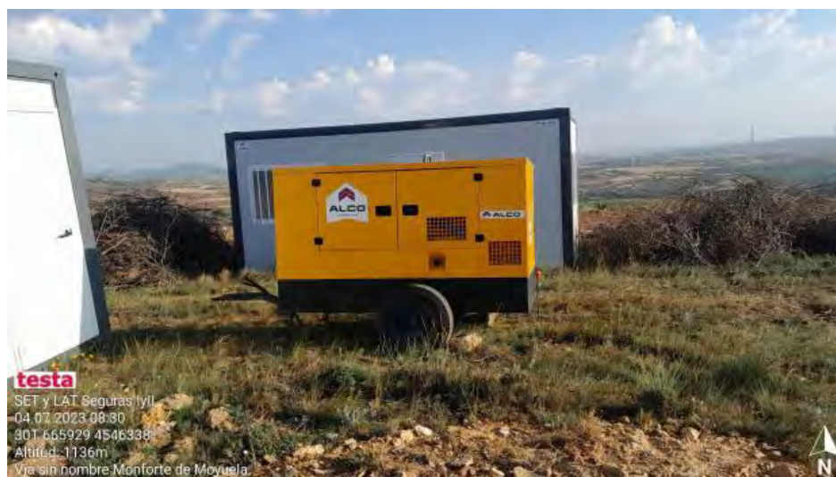
Generador sin la debida protección del suelo.
