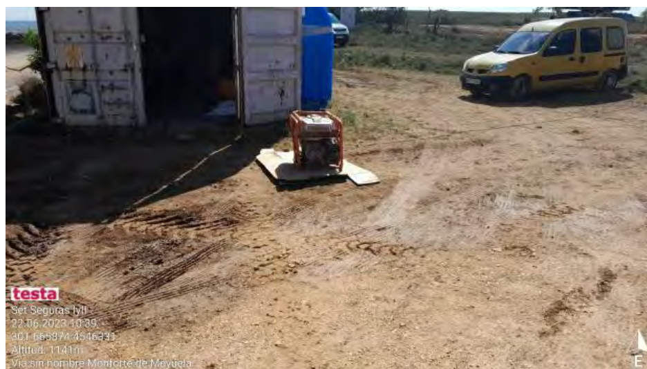
Generador con protección deficiente.
