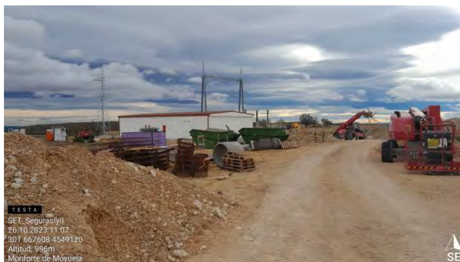
Punto limpio en SET Seguras
