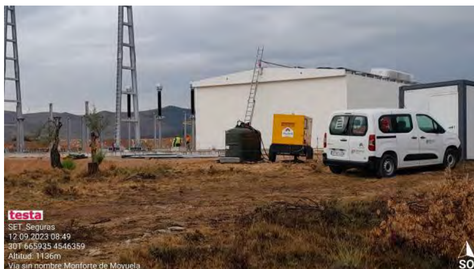
Generador más depósito de combustible.
