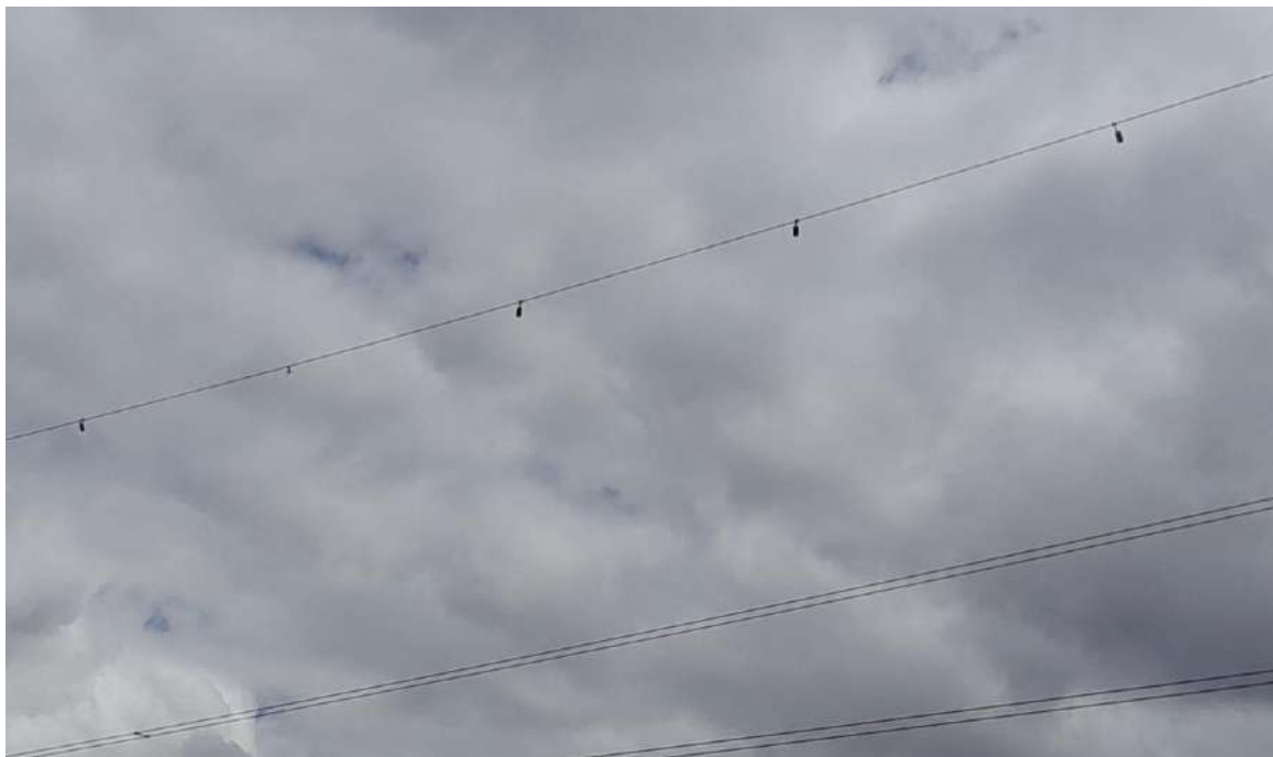
Salvapájaros en la línea eléctrica
