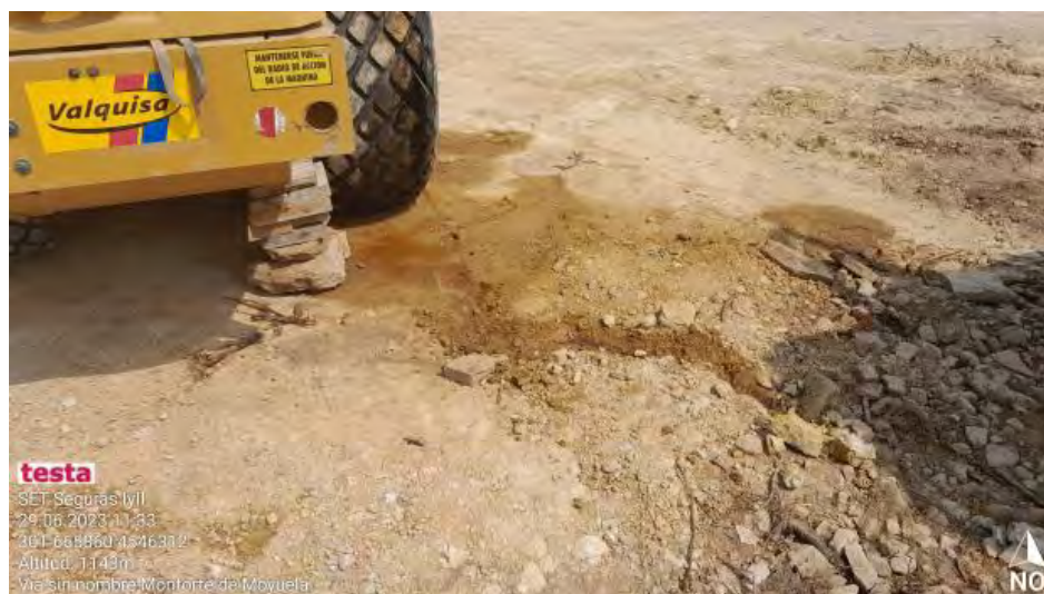
Derrame por avería en máquina.
