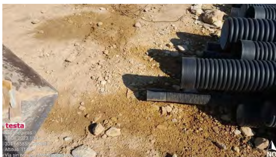
Derrame en punto limpio .
