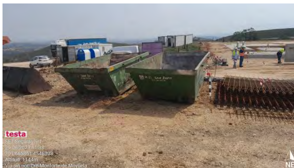
Contenedores de RNP en SET.
