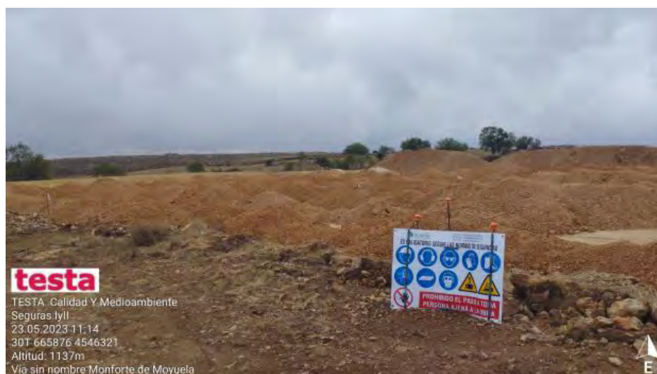
Acopio de zahorra en SET
