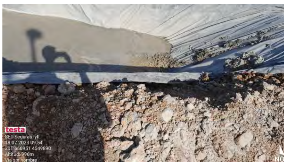
Pozo de lavado correcto en SET Monforte.
