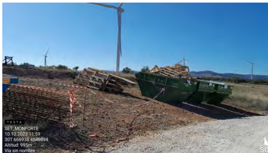
Vaciado y organizacion de contenedores de RNP insuficiente en SET Monforte.
