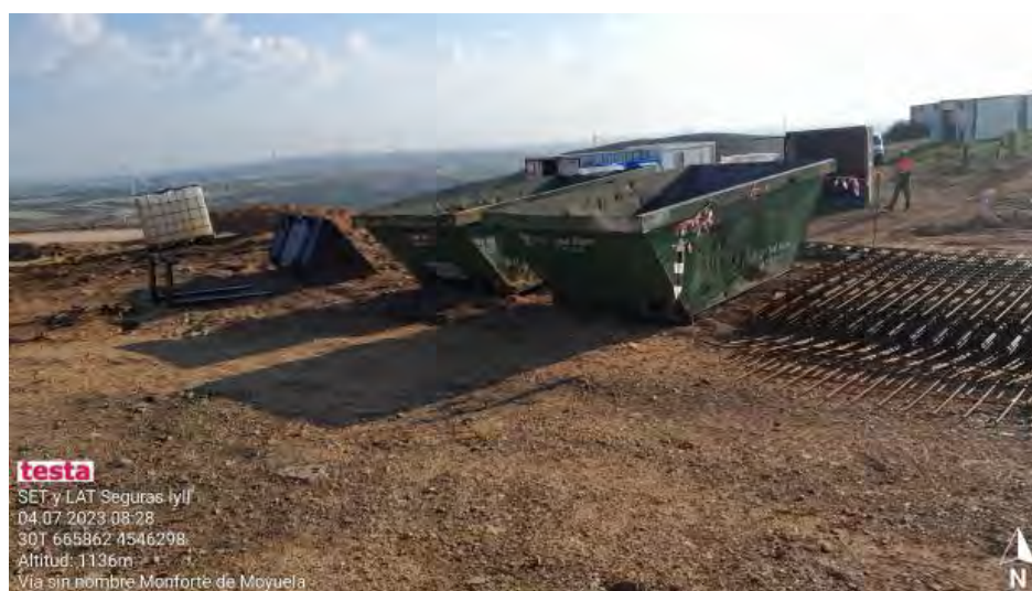
Contenedores de RNP en SET.
