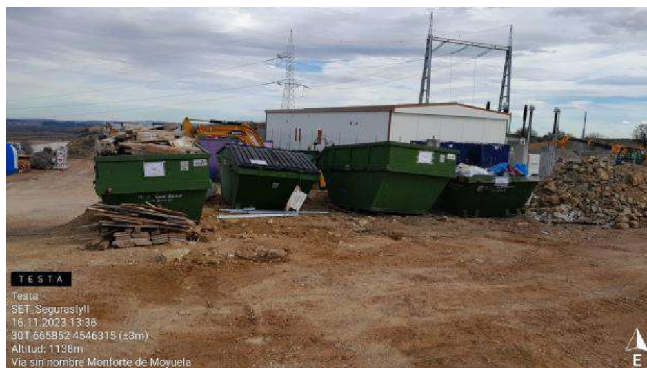
Punto limpio sin gestionar en SET Seguras.
