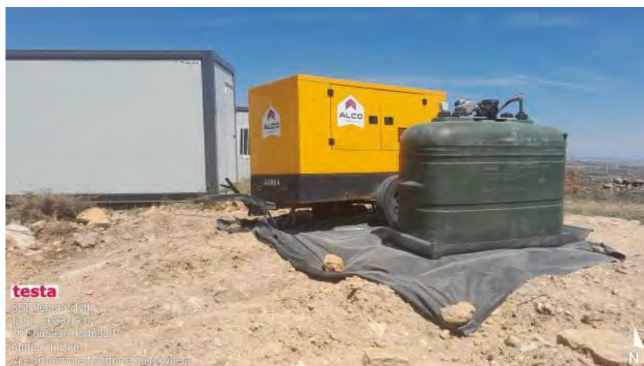
Generador y depósito con protección de suelo .
