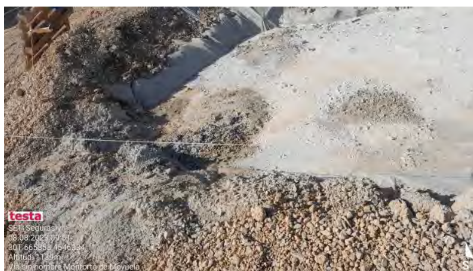
Pozo de lavado en SET Seguras.
