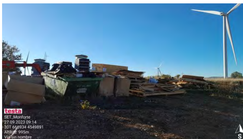
Contenedores de RNP llenos en SET Monforte.
