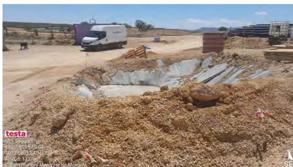
Pozo de lavado inadecuado
