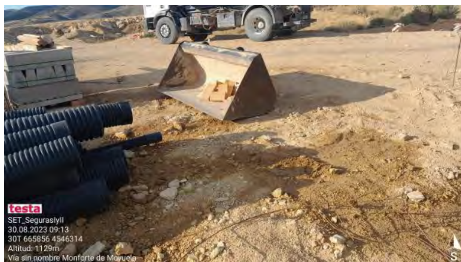
Derrame en punto limpio .
