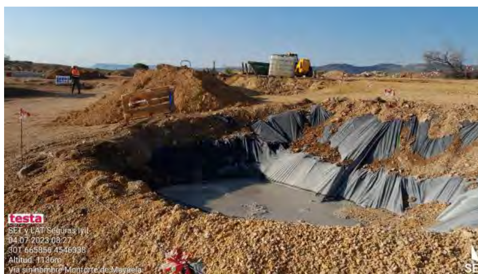
Pozo de lavado inadecuado
