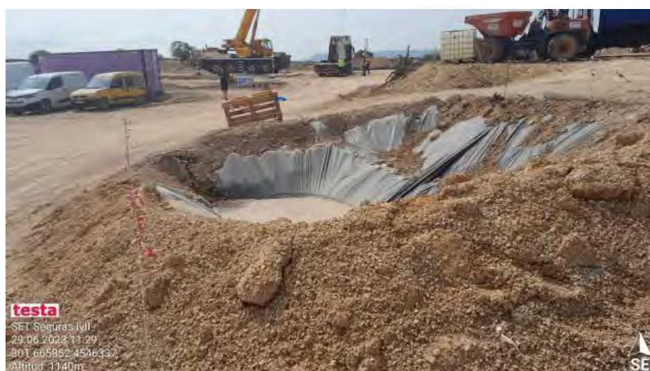
Pozo de lavado inadecuado
