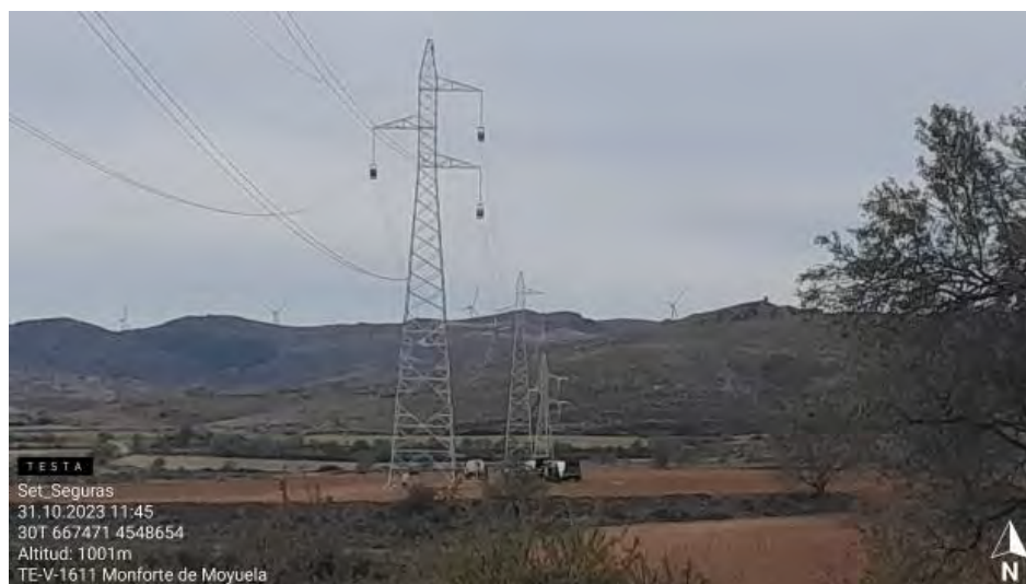
Cableado en LAT
