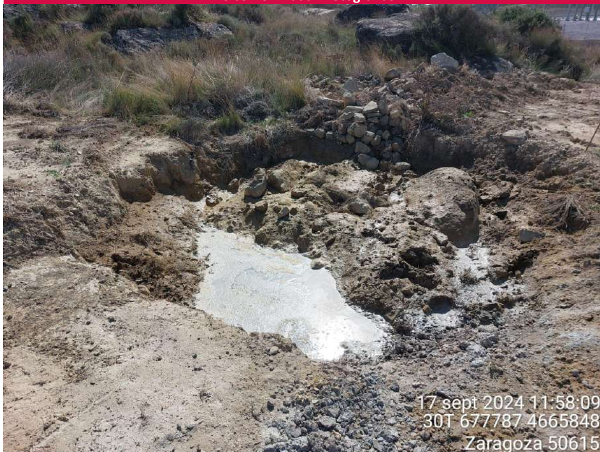
Imagen 1. No conformidad grave. Lavado de cuba de hormigón en pozo de lavado sin impermeabilización del suelo.
