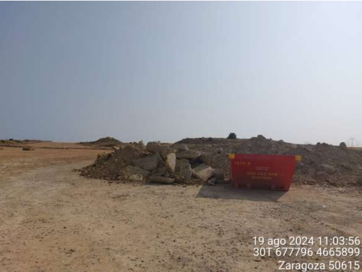
Imagen 1. Material acopiado en zona próxima a SET a la espera de ser transportado a planta.
