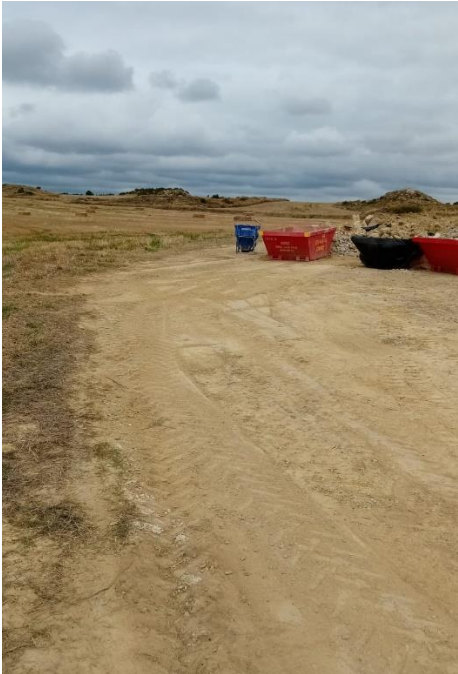
Fotografías zona escape de contenedor:
