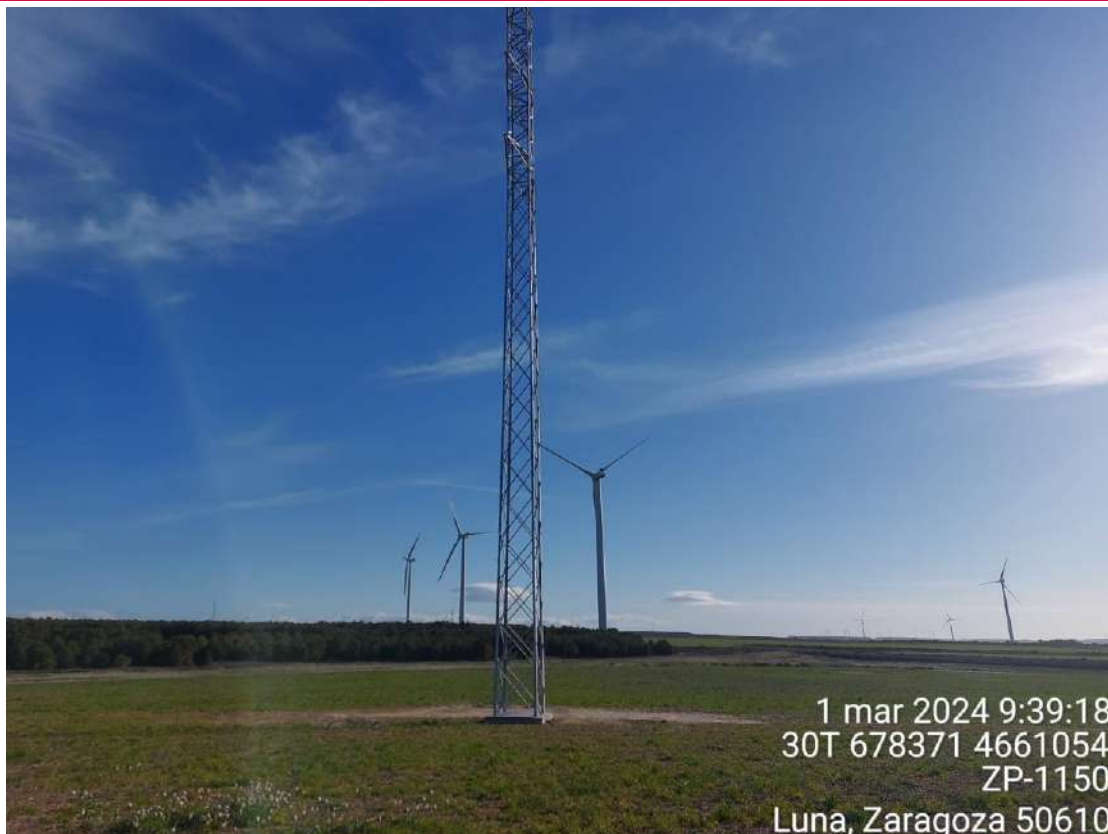
Imagen 1. Apoyo montado en LAT San Licer.
