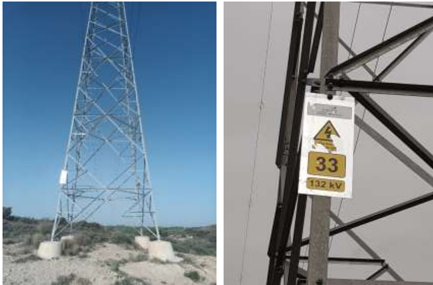
Fig.2. Balizas salva-pájaros y señalización de los apoyos.
