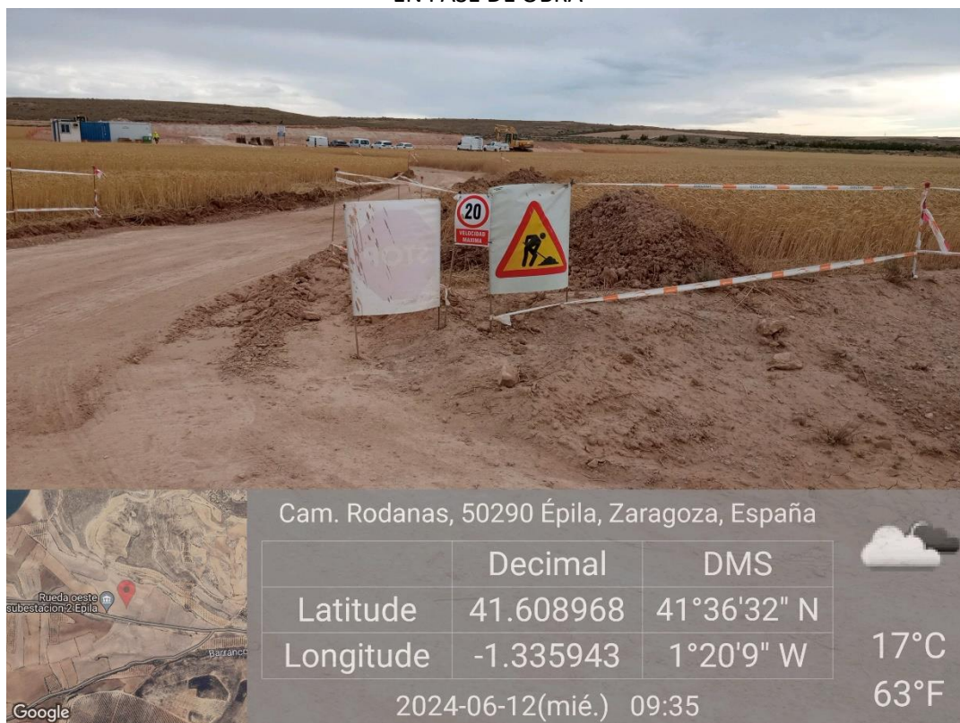
Ilustración 9. Señalización de la SET Oeste.
