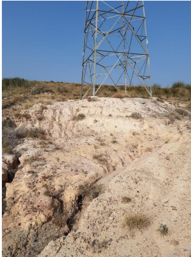
Fig 3. Erosión en el apoyo 20.
