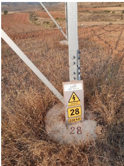
Fig 1. Cartel caído del apoyo 28.
