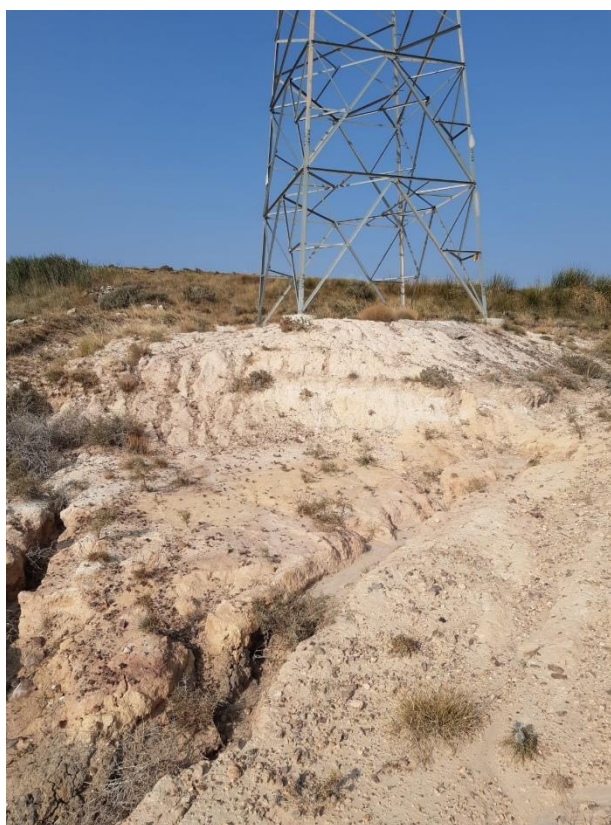
Fig 3. Erosión en el apoyo 20.
