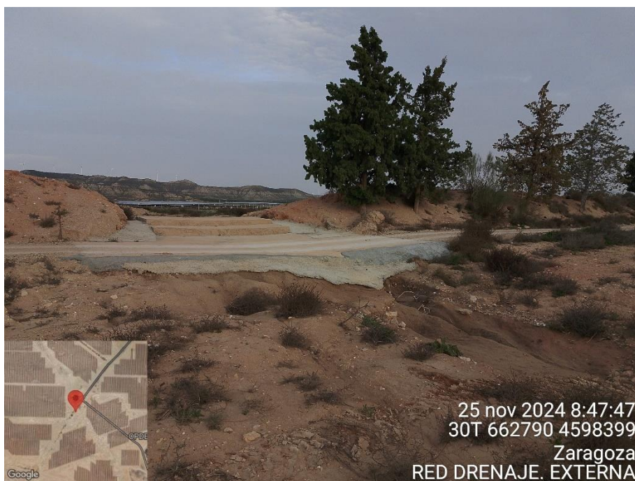
Fotografía 10. Red de drenaje externa a la PSFV
