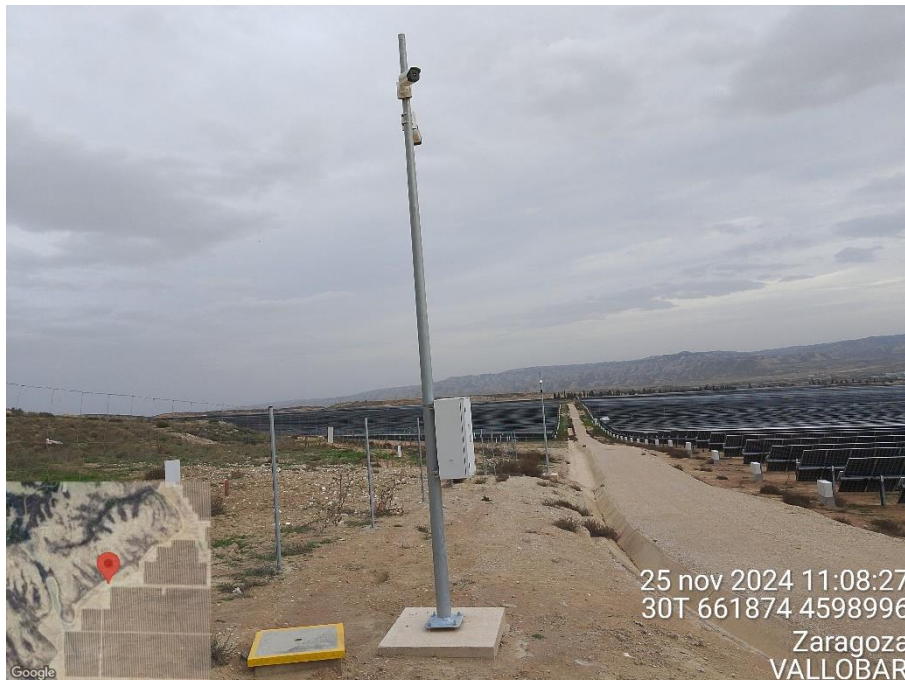
Fotografía 9. Videocámara y red de drenaje de la PSFV
