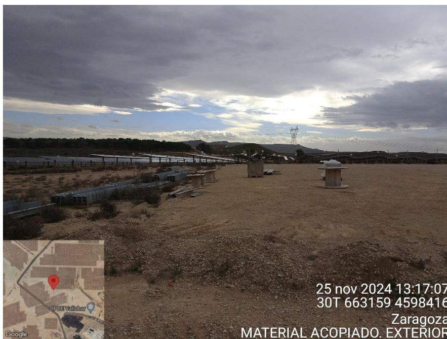
Fotografía 12. Material acopiado en el exterior de la PSFV
