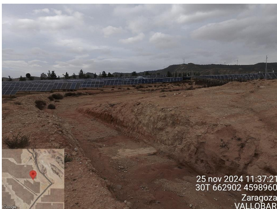
Fotografía 3. Infraestructuras de drenaje en el interior de la PSFV
