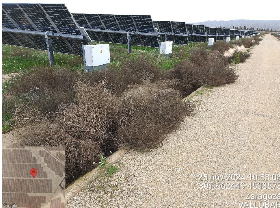
Fotografía 4. Infraestructuras de drenaje taponadas en el interior de la PSFV
