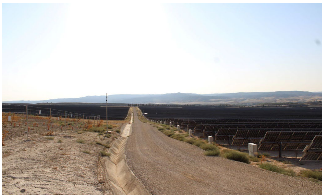
Fotografía 5. Infraestructuras de drenaje en PSFV Vallobar
