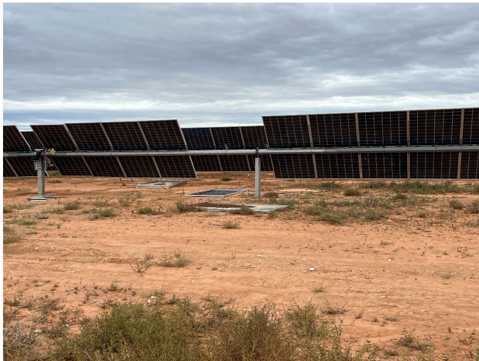
Figura 7 Módulos y seguidores rotos
