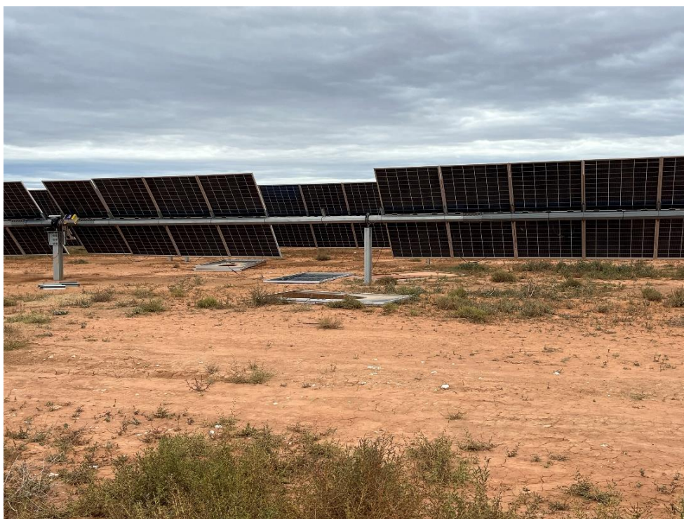
Fotografía 5: Módulos y seguidores rotos en septiembre-noviembre 2023
