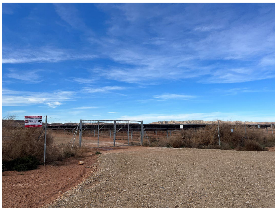
Figura 8 Acumulación de capitanas en el vallado perimetral
