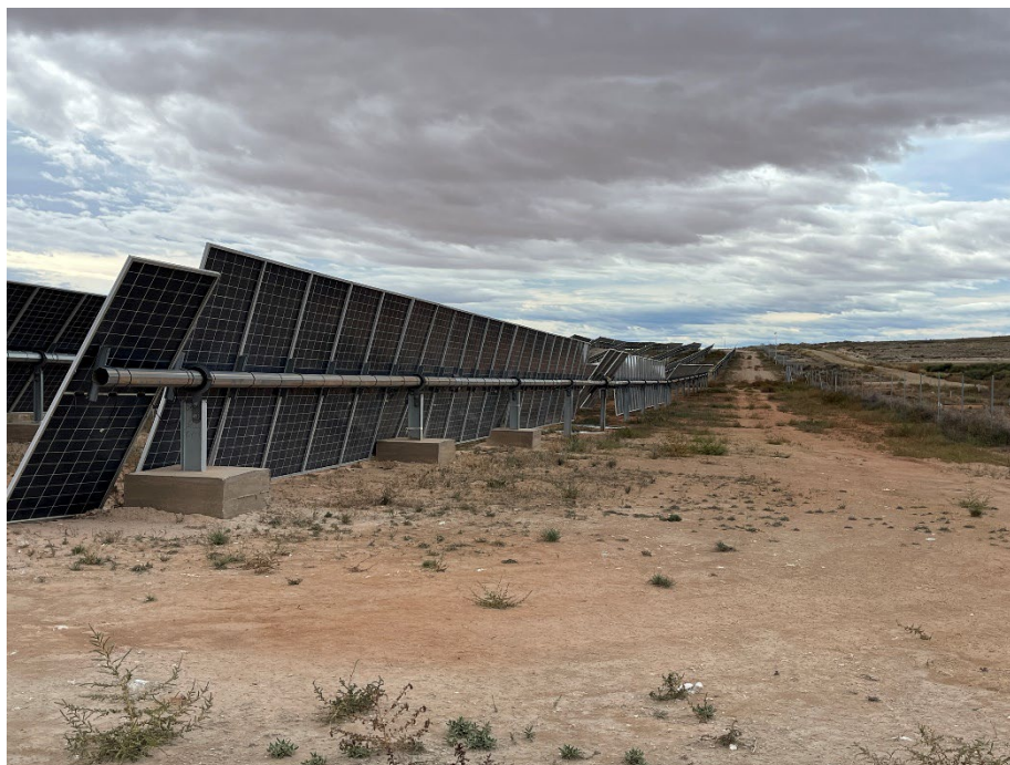
Figura 9 Módulos y seguidores rotos
