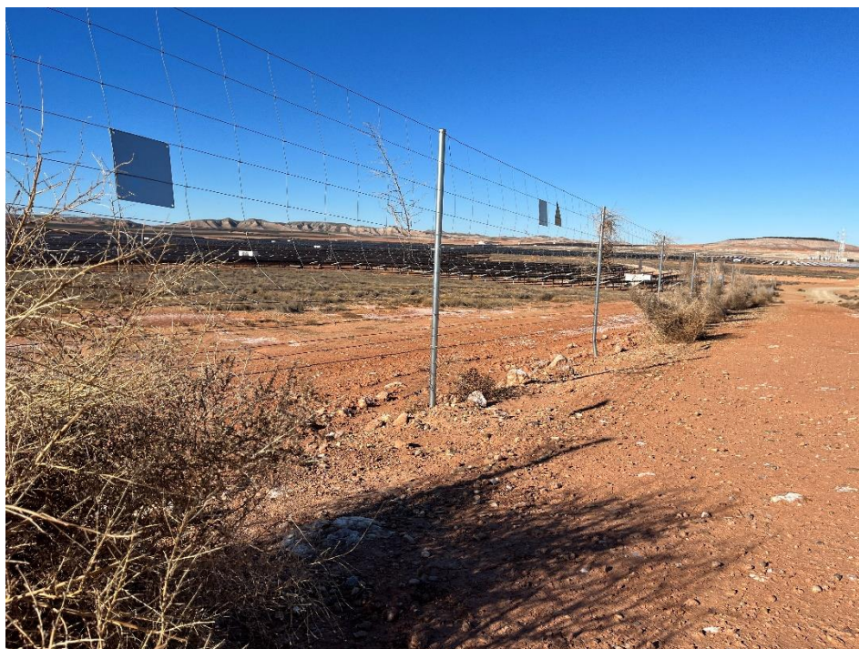
Fotografía 13: Afección al vallado perimetral por las capitanas
