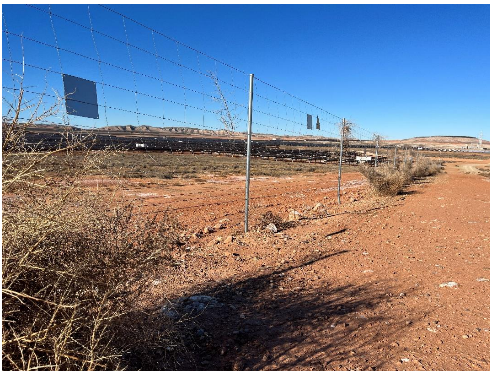
Fotografía 10: Afección al vallado perimetral por las capitanas
