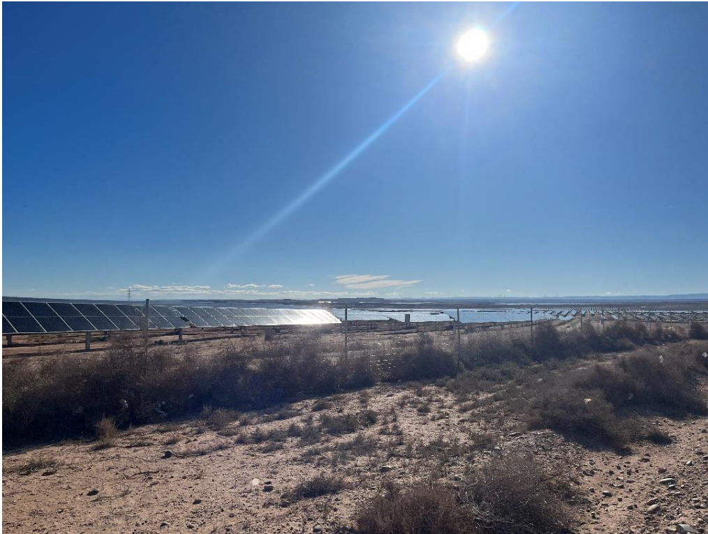
Fotografía 7: Acumulación de capatana en el vallado perimetral
