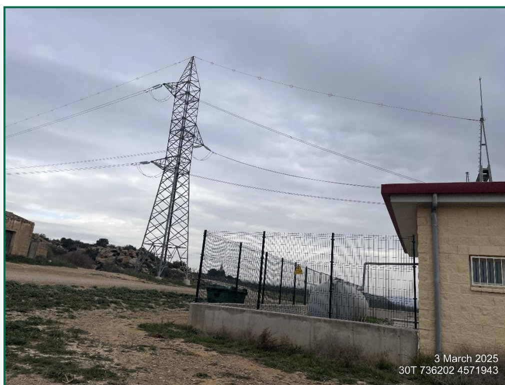
Fotografía 7. Línea eléctrica con balizas salvapájaros
