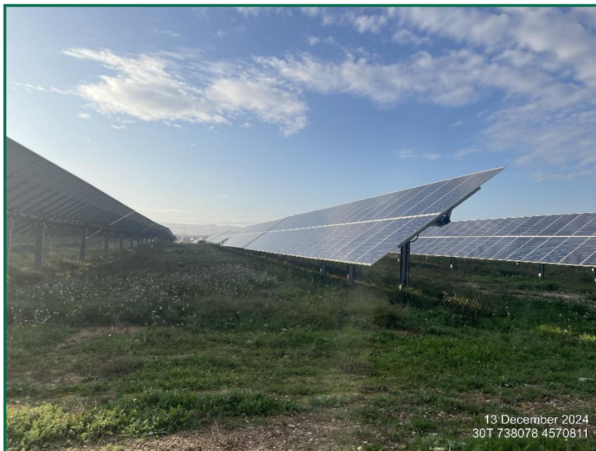
Fotografía 2. Vegetación entre placas actualmente.
