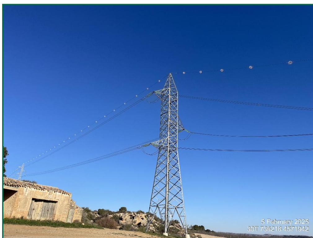
Fotografía 10. Línea eléctrica con balizas salvapájaros
