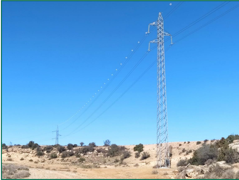
Fotografía 11. Línea eléctrica con balizas salvapájaros
