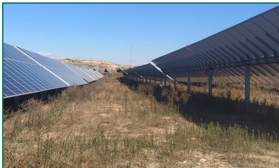
Fotografía 1. Vegetación entre placas actualmente.
