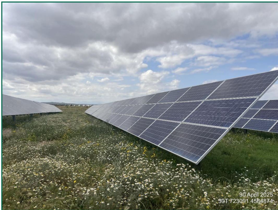
Fotografía 1.Vegetación entre placas en su estado actual.
