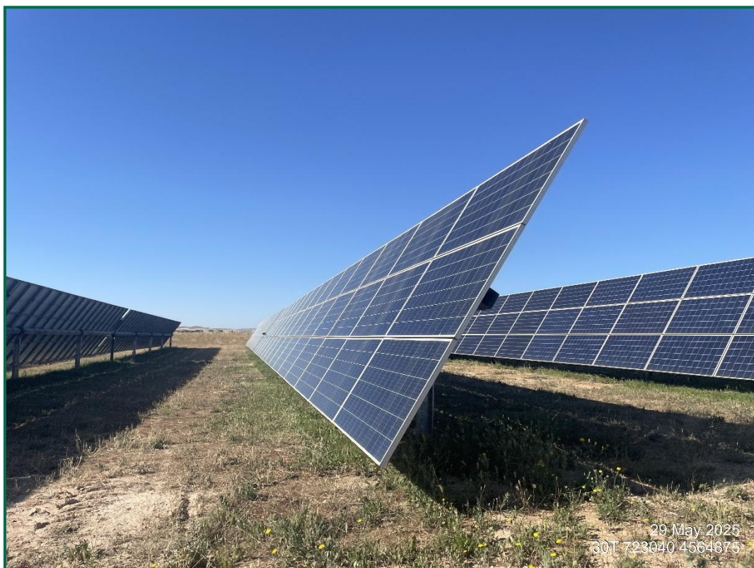
Fotografía 2.Vegetación entre placas en su estado actual.
