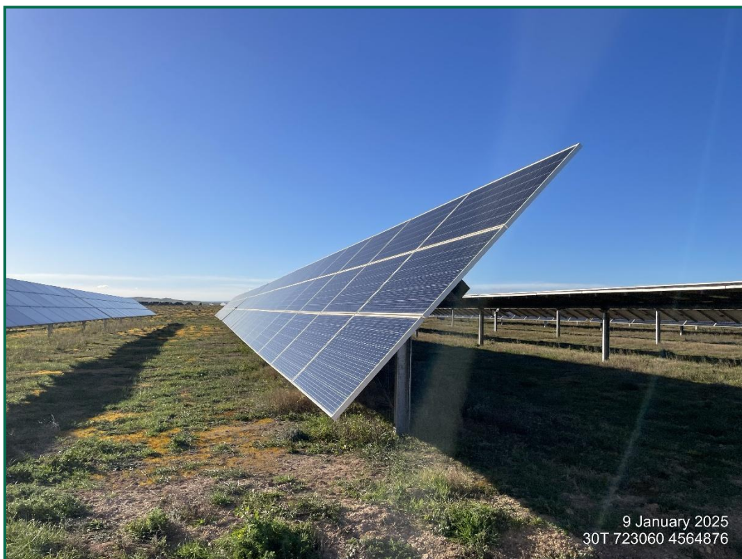
Fotografía 2. Vegetación entre placas en su estado actual.
