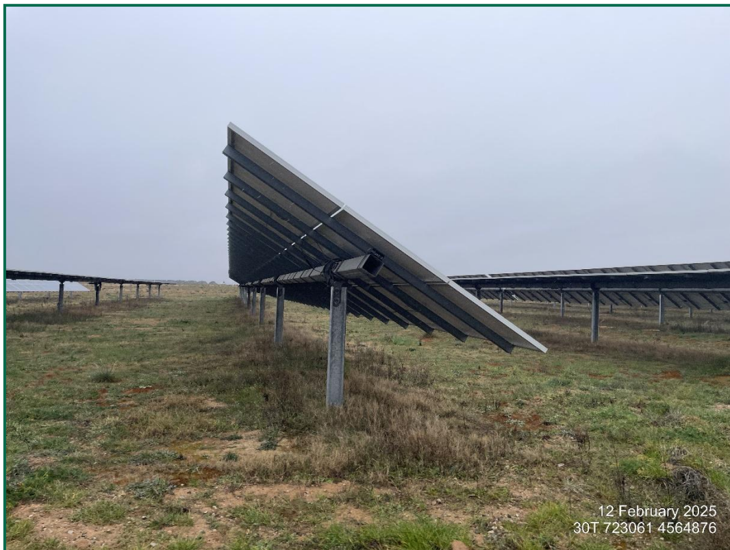
Fotografía 1. Vegetación entre placas en su estado actual.
