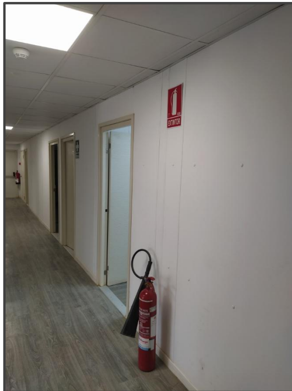
Fotografía 31. Extintores en edificio de control.
