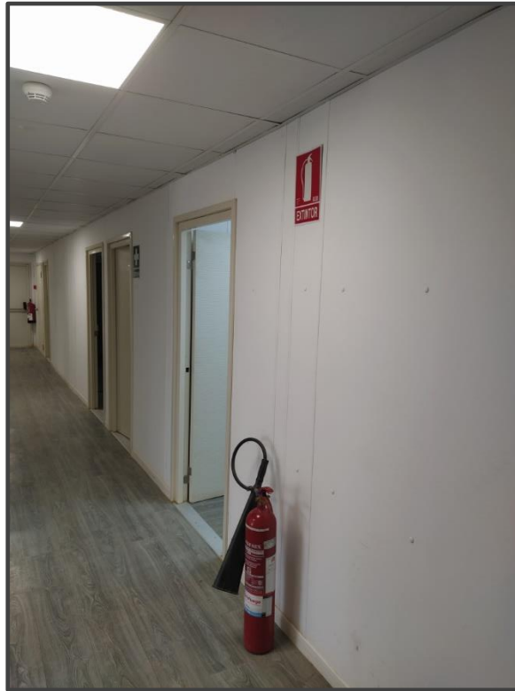
Fotografía 32. Extintores en edificio de control.
