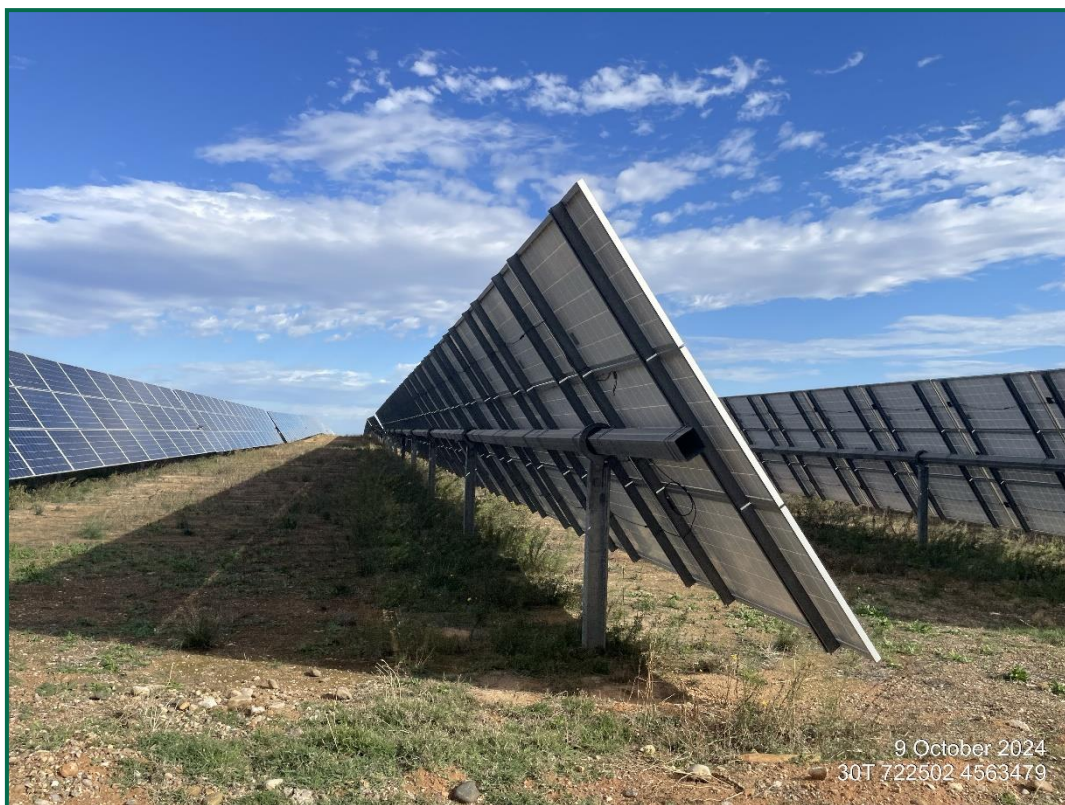
Fotografía 2.Vegetación entre placas en su estado actual.
