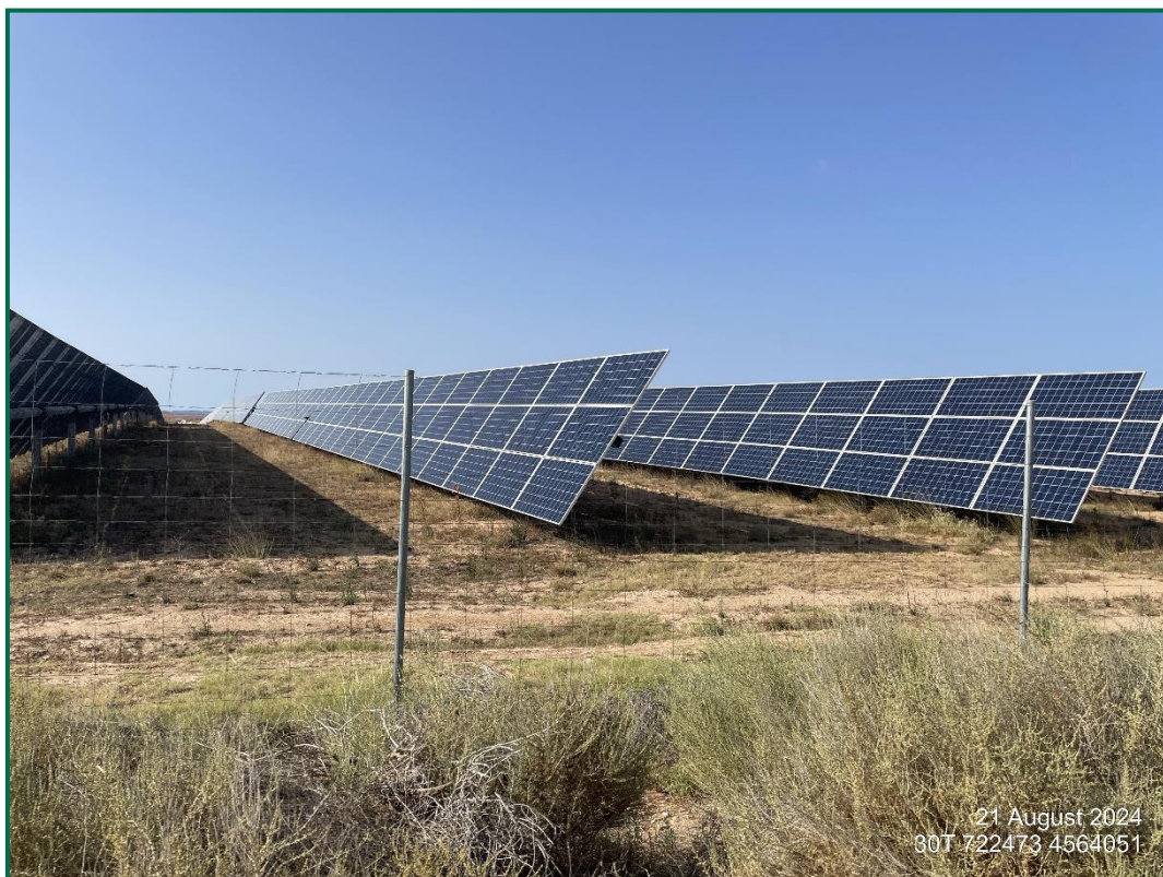
Fotografía 1.Vegetación entre placas en su estado actual.
