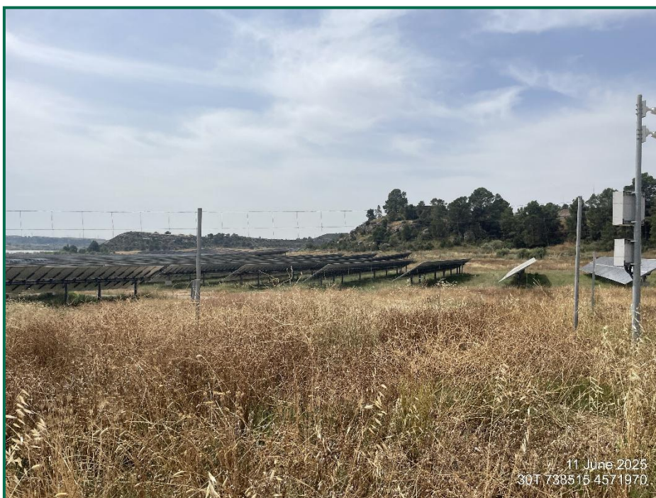
Fotografía 2. Vegetación entre placas actualmente.
