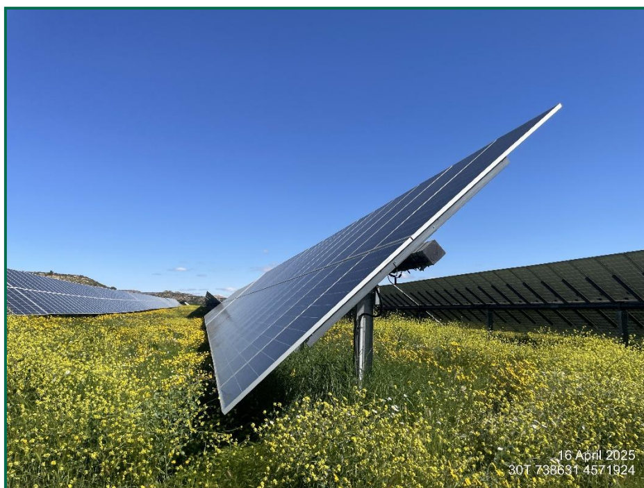
Fotografía 1. Vegetación entre placas actualmente.
