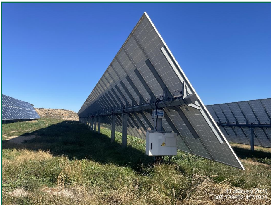
Fotografía 2. Vegetación entre placas actualmente.
