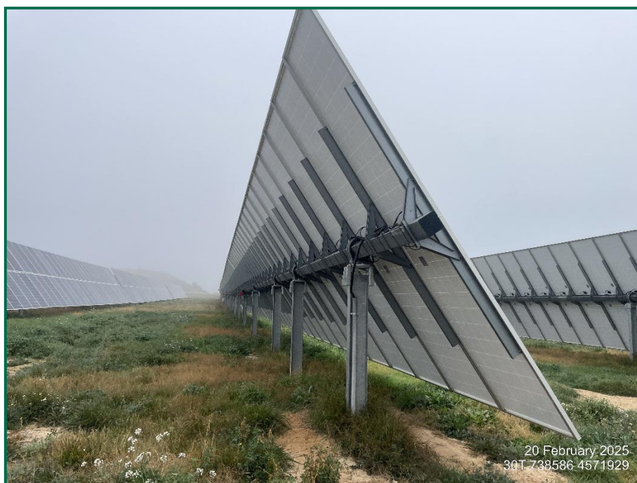
Fotografía 1. Vegetación entre placas actualmente.
