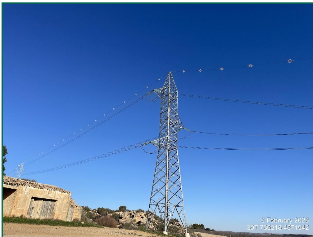
Fotografía 5. Línea eléctrica con balizas salvapájaros
