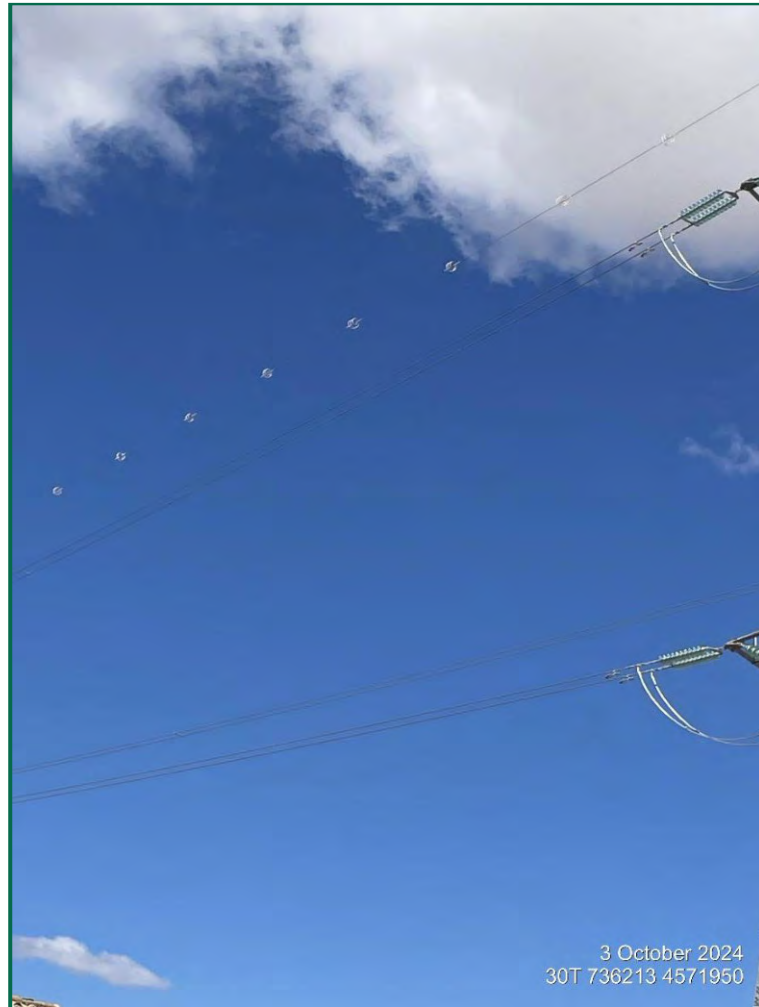
Fotografía 5. Línea eléctrica con balizas salvapájaros
