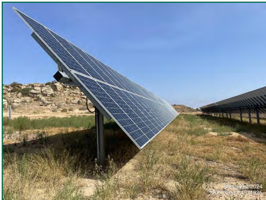
Fotografía 1. Vegetación entre placas actualmente.
