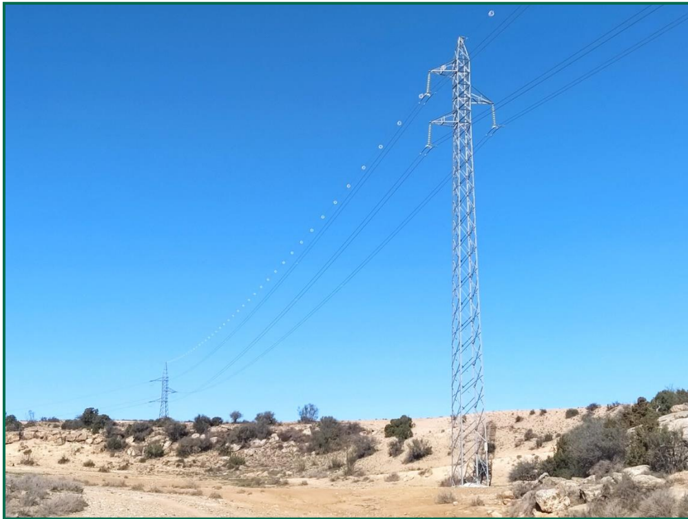
Fotografía 5. Línea eléctrica con balizas salvapájaros
