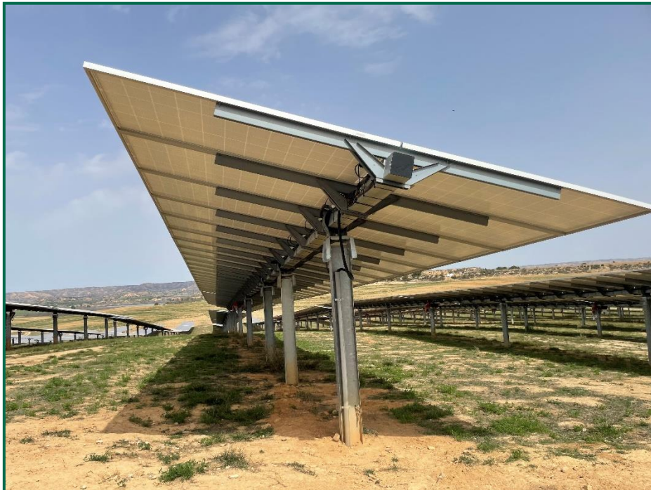
Fotografía 1. Vegetación entre placas actualmente.
