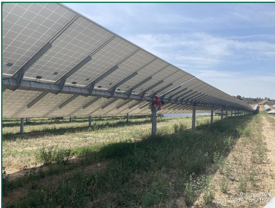
Fotografía 2. Vegetación entre placas actualmente.
