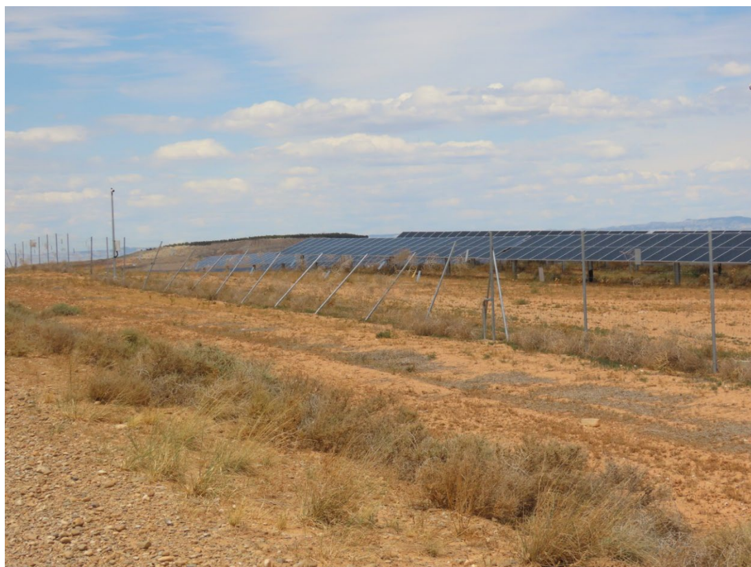
Figura 2. Tramo del vallado tumbado
