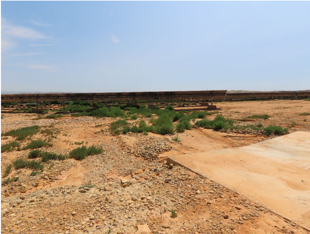
Figura 3. Zona de arrastre y erosión por lluvia en San Miguel B
