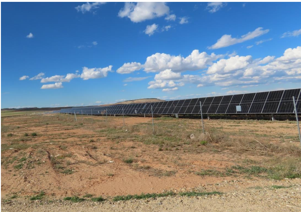
Fotografía 6: Estado general de limpieza vallado perimetral en el último trimestre del ciclo anual (marzo-mayo 2024))
