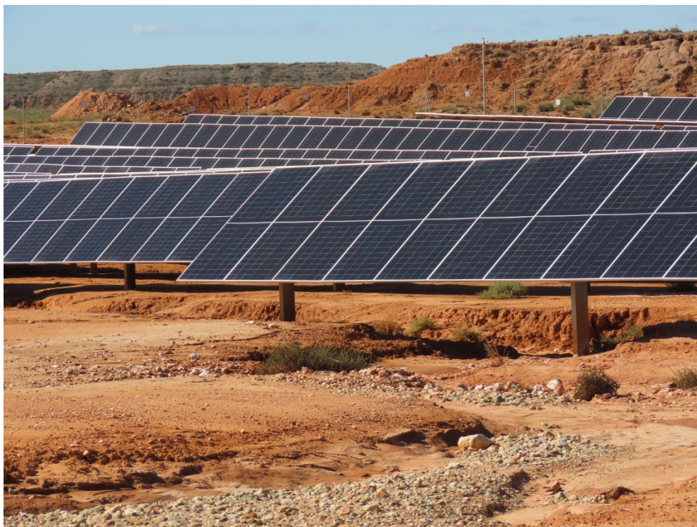
Figura 7. Regueros próximos a las estructuras de los paneles en San Miguel A.
