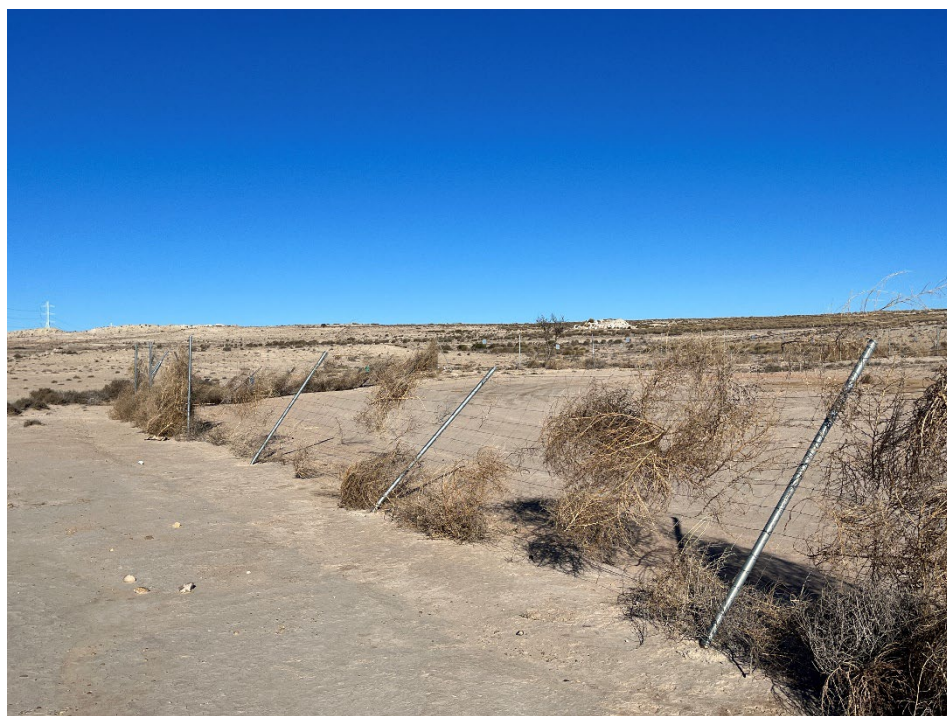
Figura 8 Afección al vallado por acumulación de capitanas
