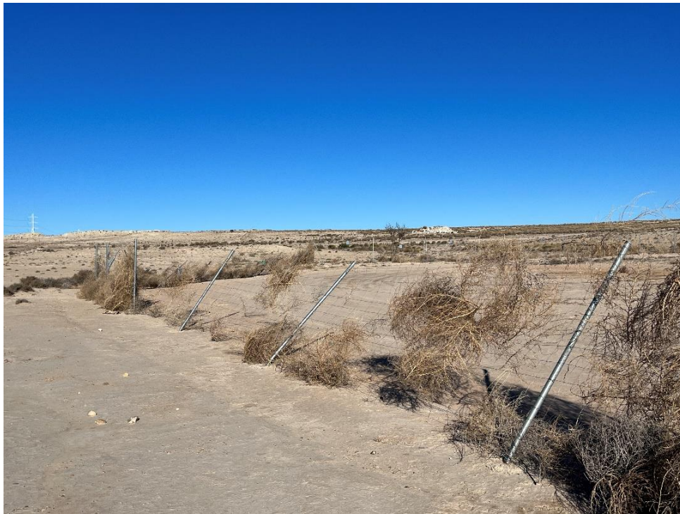
Fotografía 5: Vallado perimetral afectado por la proliferación de capitanas
