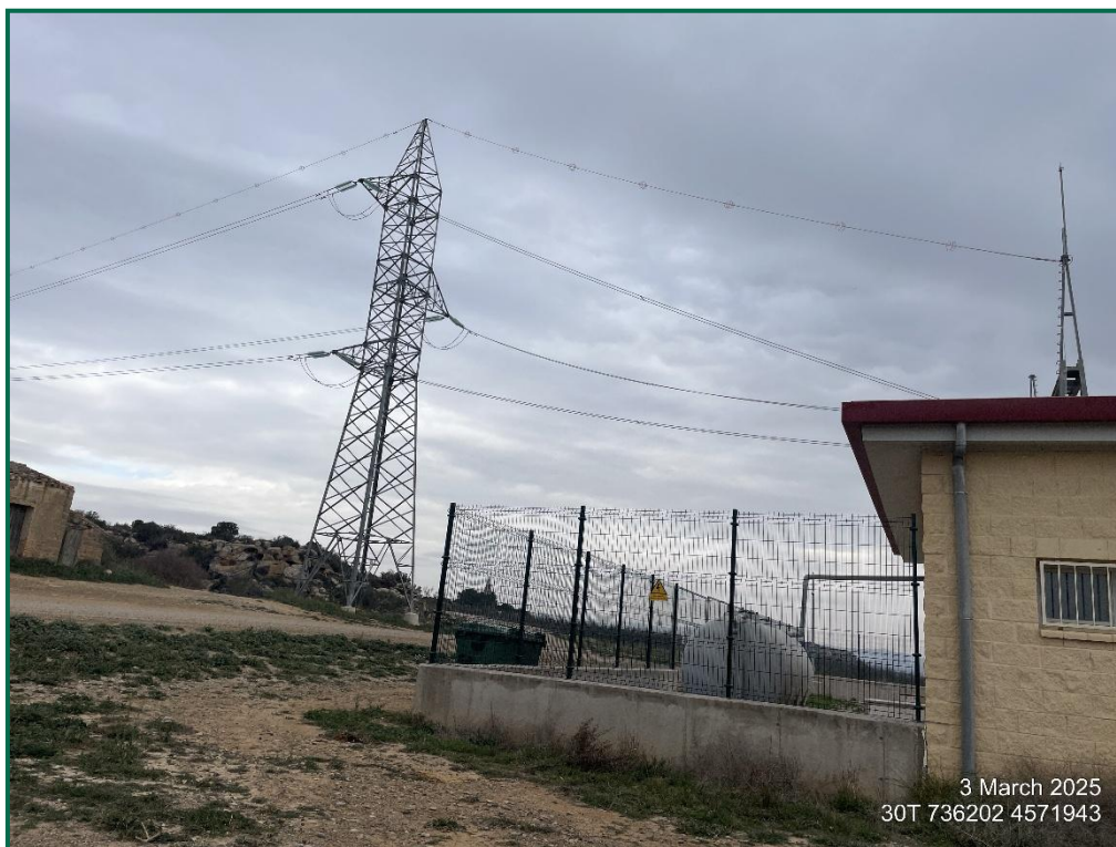
Fotografía 5. Línea eléctrica con balizas salvapájaros
