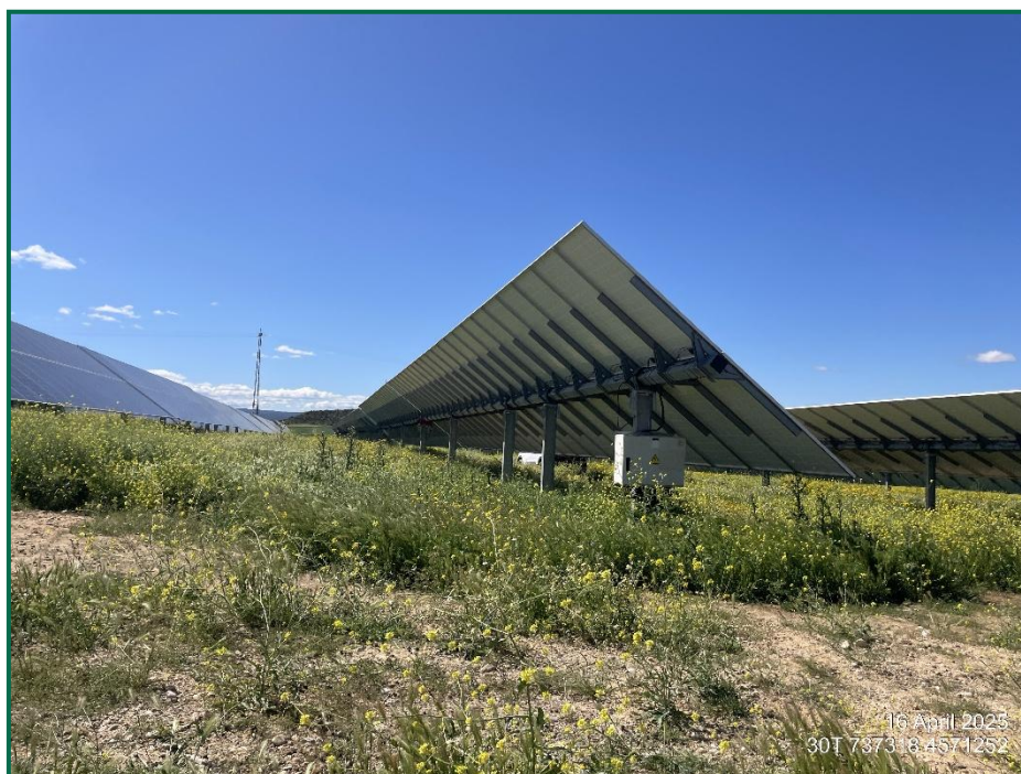
Fotografía 2. Vegetación entre placas actualmente.
