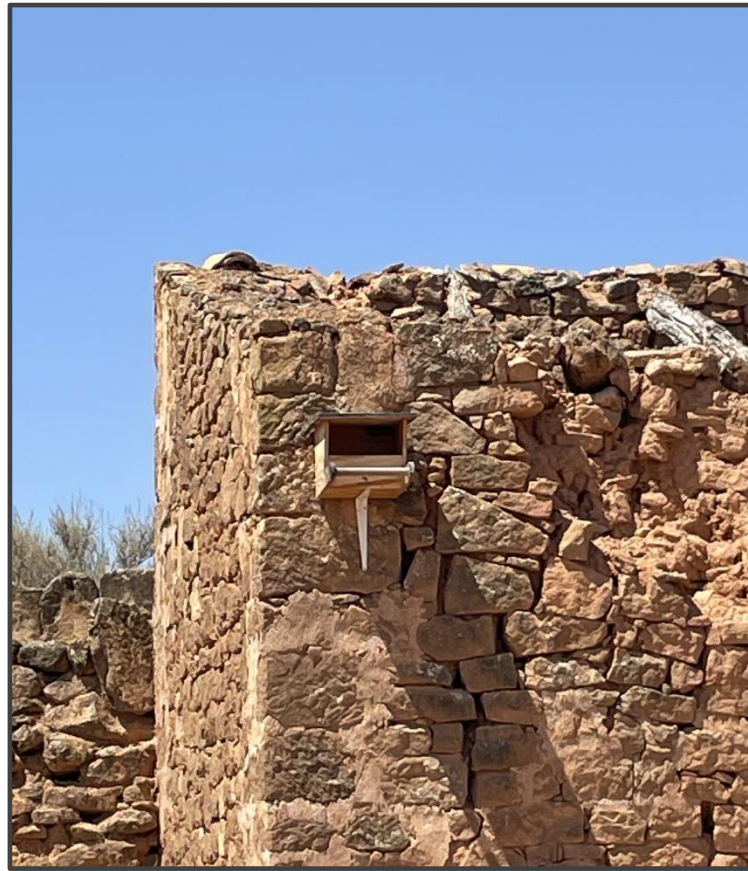
Fotografía 23. Caja para rapaz sobre construcción.
