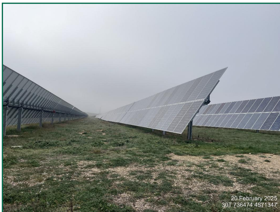
Fotografía 2. Vegetación entre placas actualmente.
