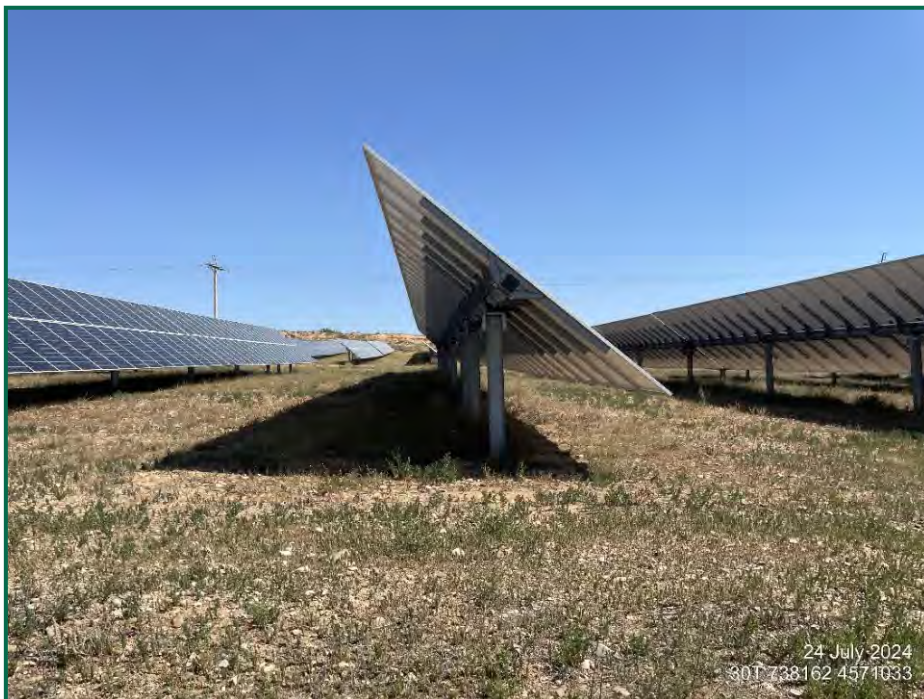
Fotografía 2. Vegetación entre placas actualmente.
