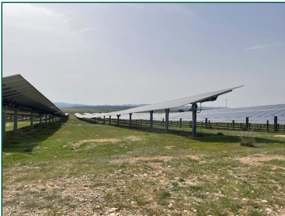
Fotografía 2. Vegetación entre placas actualmente.
