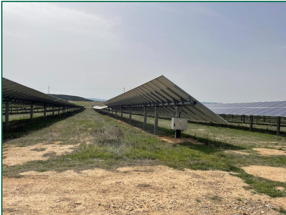
Fotografía 1. Vegetación entre placas actualmente.
