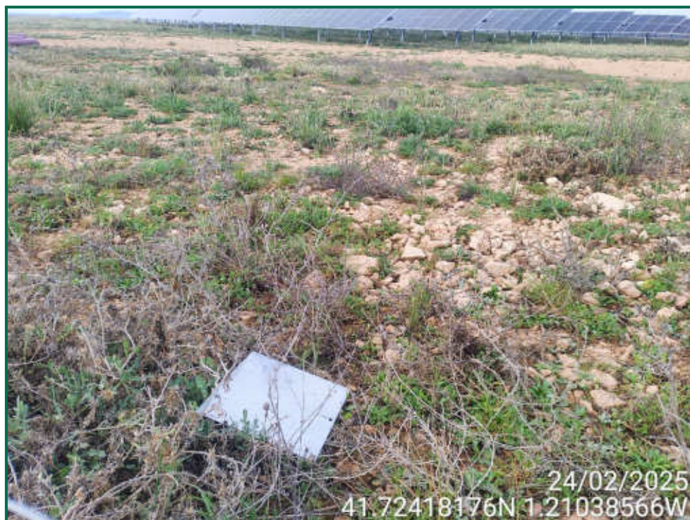
Fotografía 23. Placa anticollisión desprendida.
