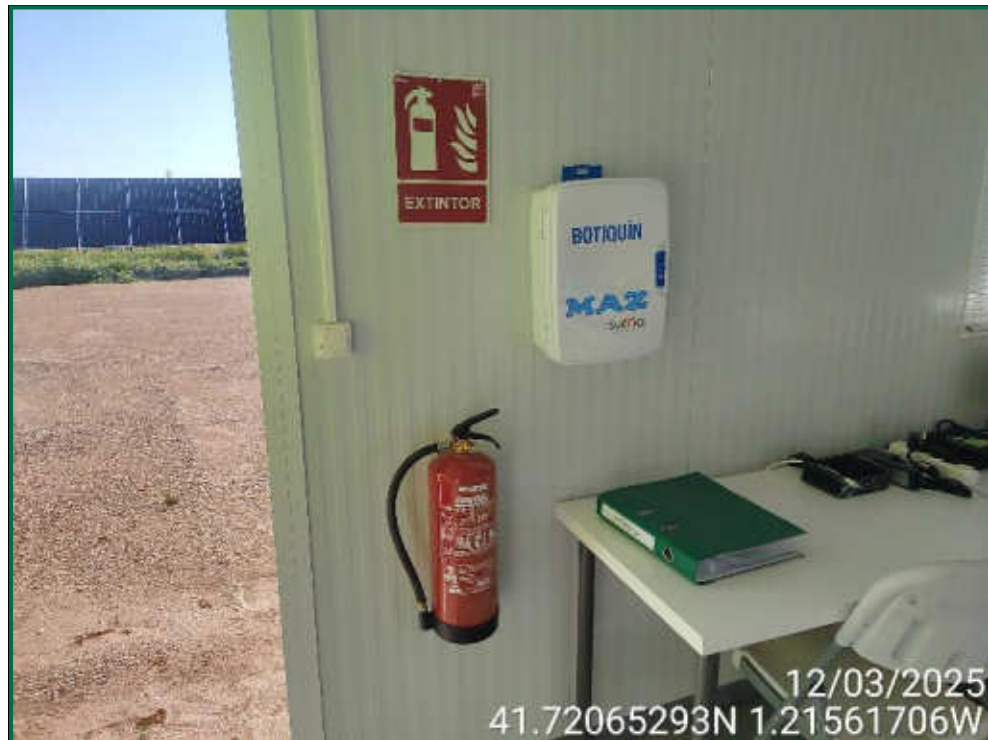
Fotografía 27. Extintor en la caseta de control.
