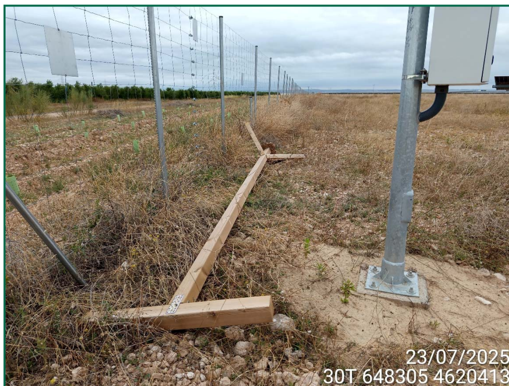
Fotografía 27. Posadero desprendido después del temporal.
