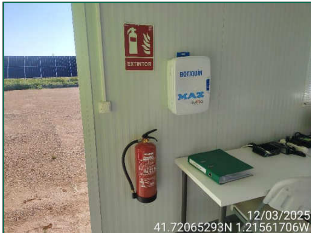
Fotografía 27. Extintor en la caseta de control.
